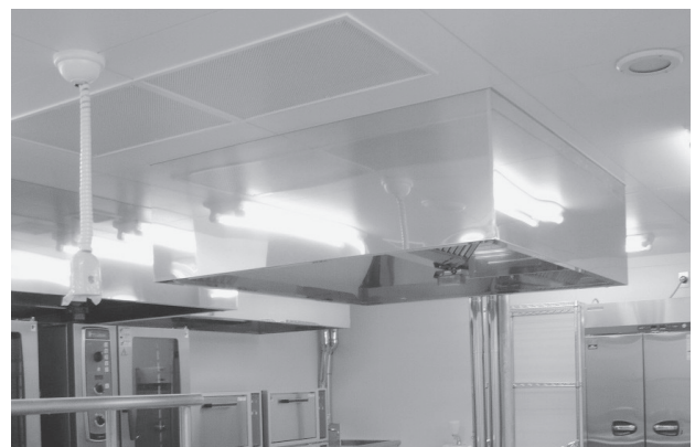
写真-10 多孔板からの緩やかな給気による換気
