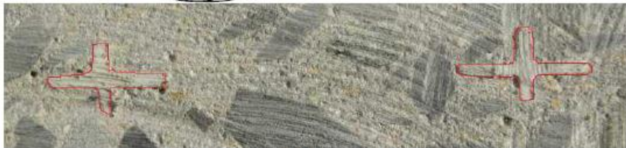
コンクリートを打設した星型スペーサ（プラ・スターG）の切断面
