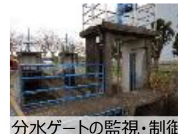
分水ゲートの監視・制御
