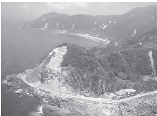
写真5 がけ崩れによる神津島周回道路の被害（2000年神津島近海地震）
