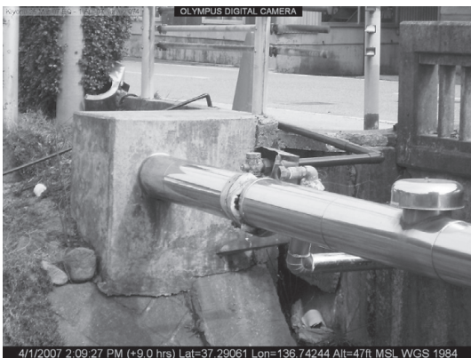
写真8 水管橋の破損(2000年能登半島地震)
