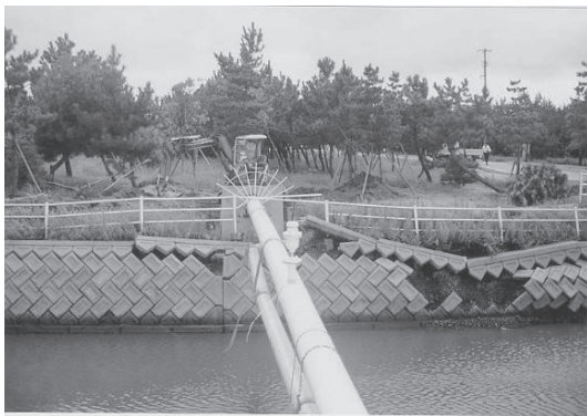
写真6 承水路に架かる水管橋の被害状況（2000年鳥取県西部地震）
