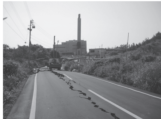
写真9 水道管が敷設されている道路の被害(2007年新潟県中越沖地震)
