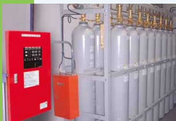
ガス系消火設備
