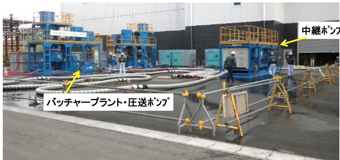
補強材供給設備設置状況
