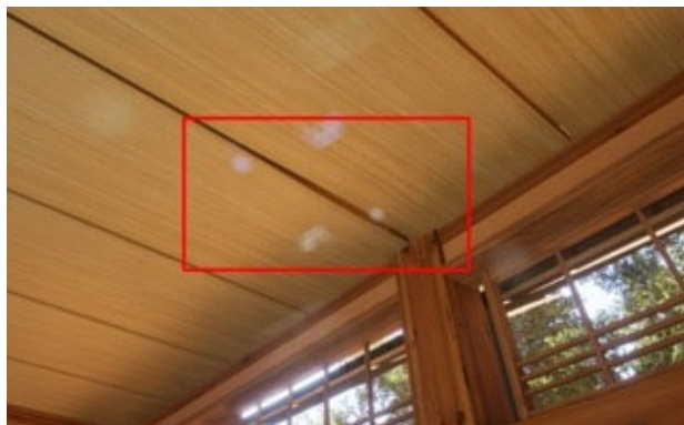
図1 1 天井板の歪みの再現例
