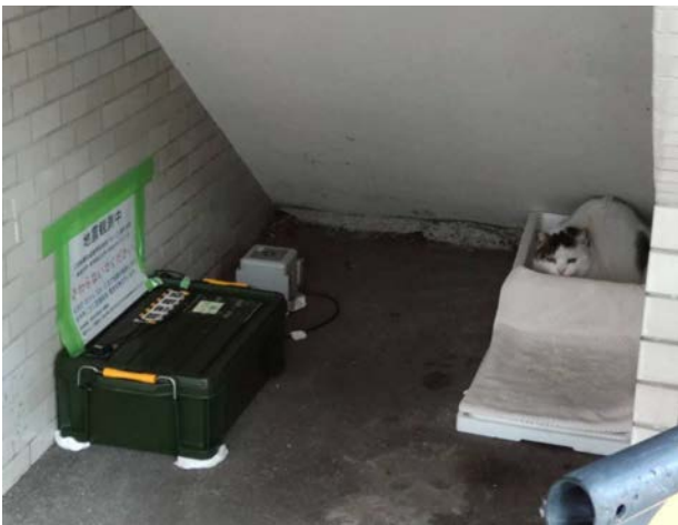
図-7 明石市・消防局中崎分署における地震計設置状況
