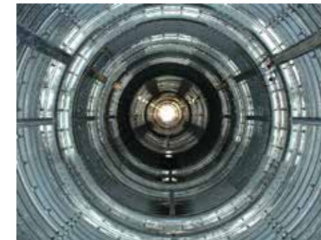
引き出しトンネル内部(設備設置前)
