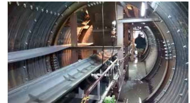
引き出しトンネル内部(設備設置後)
