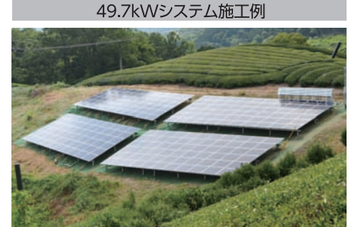
49.7kWシステム施工例
