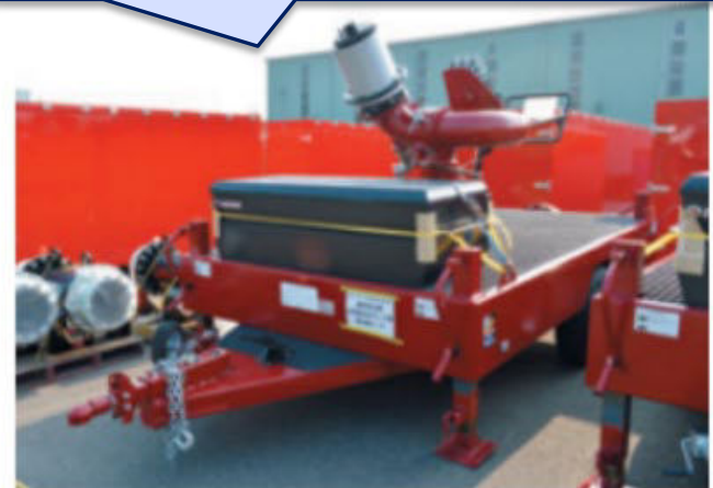
屋外放水設備
