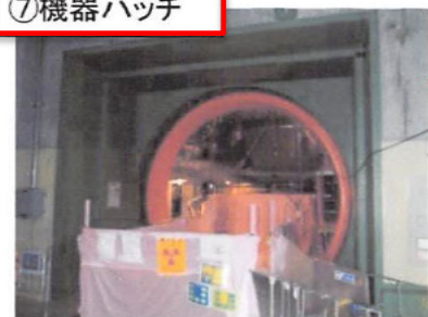
⑦機器ハッチ
