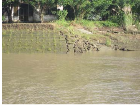
Twante 地区堤防被害 2 (東側)
