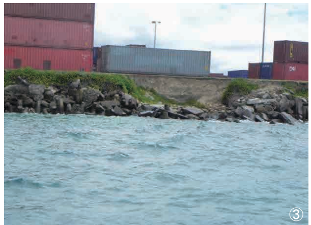
護岸の洗掘部の状況
