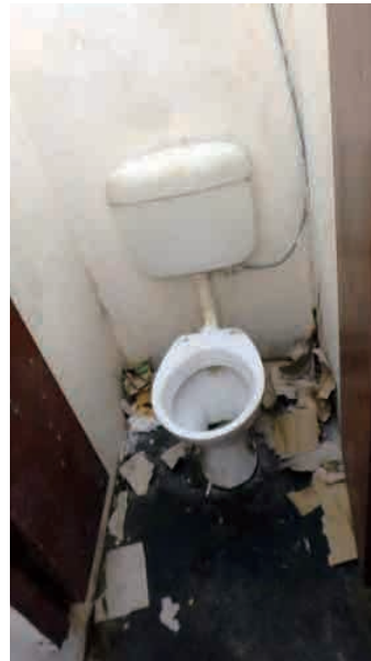
港湾内のトイレは衛生状態が悪い。
