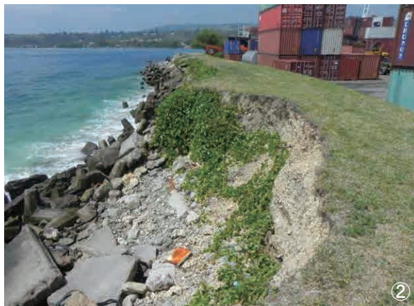
護岸の洗掘部の状況
