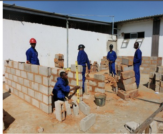
写真-4: マシャバ CFP・石工コース ブロック積み実習の状況
