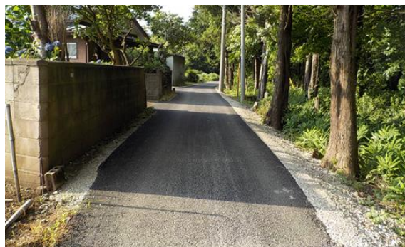
2. 農村整備 農道整備事業（認定外道路） 小田部地区他農道応急業務委託工事
