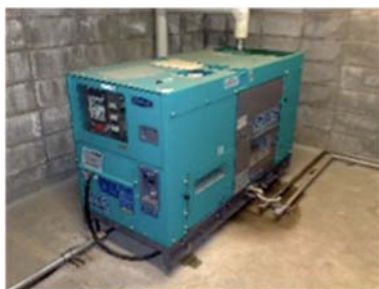
ディーゼルエンジン (排ガス発生装置)
