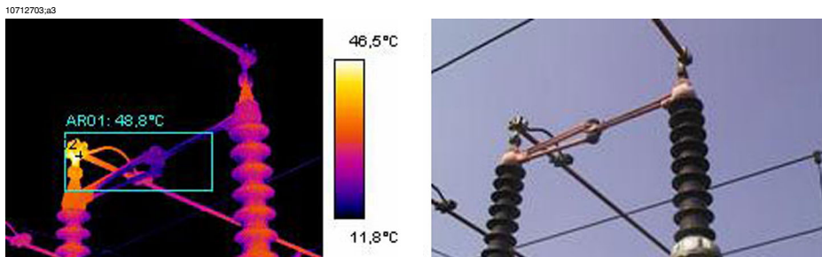
図 29.1 電源遮断機の熱画像と実画像
