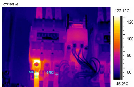
図 29.9 屋内電気設備の熱画像 (2)。
