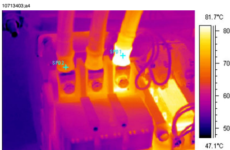
図 29.8 屋内電気設備の熱画像 (1)。
