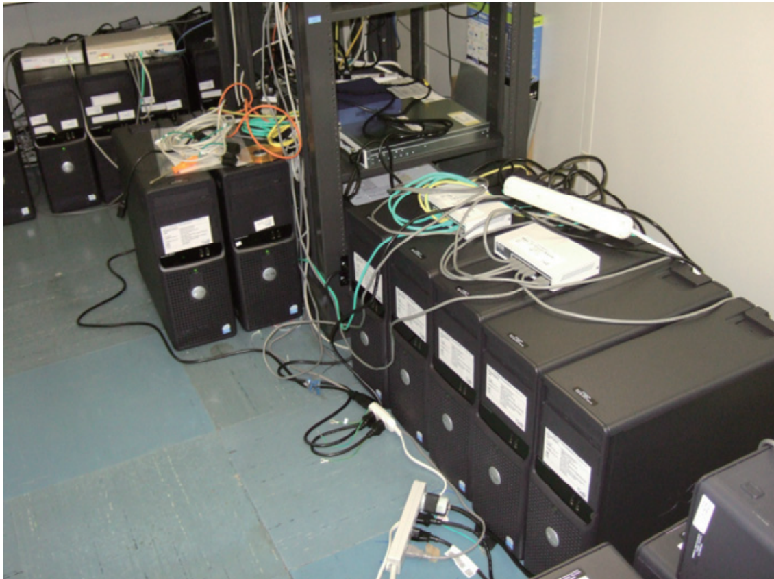
図 39 ゲートウェイシステムの各サーバコンピュータを設置した際の写真
