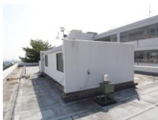
一般環境大気測定局（庁舎屋上に設置）
