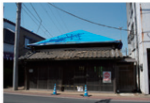
しえとも被災して休業となった。現在修復中。
