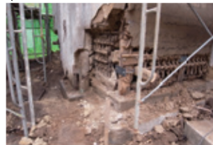
基礎、構造部、漆喰壁、老朽化がひどい。
