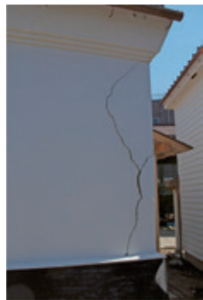
いなえの土蔵の漆喰壁にもひびが入った。
