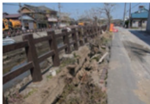
小野川の石積が一部崩壊した。
