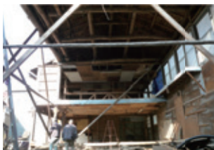
小屋組だけが残る倉庫。
