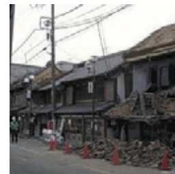
屋根瓦が落下するなどした香取市佐原地区の伝統的な町並み=千葉県文化財課提供
