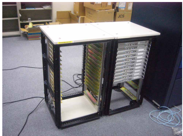
図 8: 30 分が経過し、11 台のノード計算機をラックに格納したところ。高さ 40U のラック 1 つに格納することも可能だが、20U のラックを 2 つ利用することにした。作業は一人でおこなっている。時刻は 12 時 2 分。
