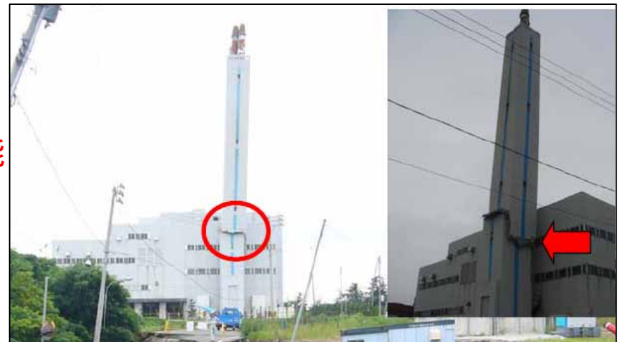
柏崎市のごみ処理施設（クリーンセンター）の被災
