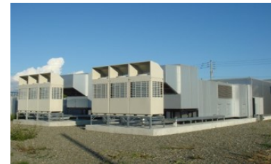
環境配慮型クラウドデータセンター
