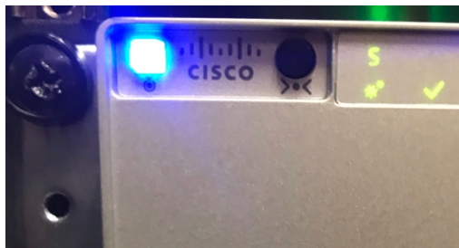
<Cisco Catalyst 9300 前面の Blue Beacon が点灯の状態>
