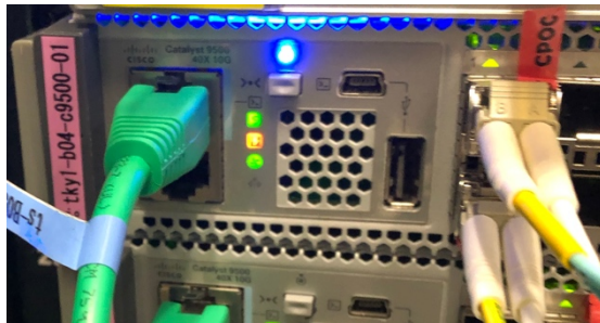
<Cisco Catalyst 9500 前面の Blue Beacon が点灯の状態>
