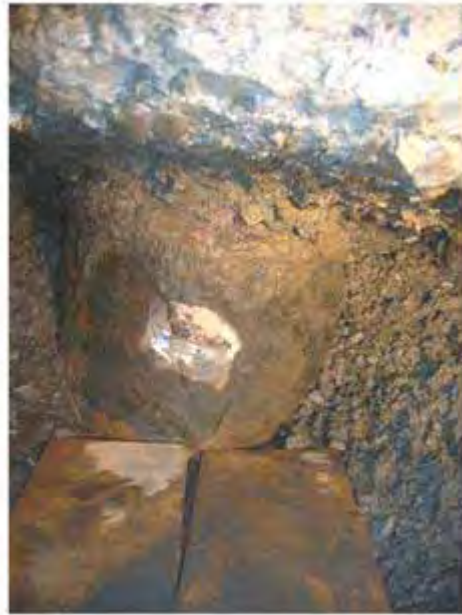
写真-2.2.1 杭頭周辺部の地盤の状況（入船南小学校）
