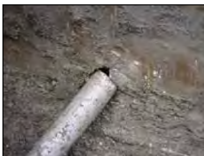
基礎部分の配管の被災
