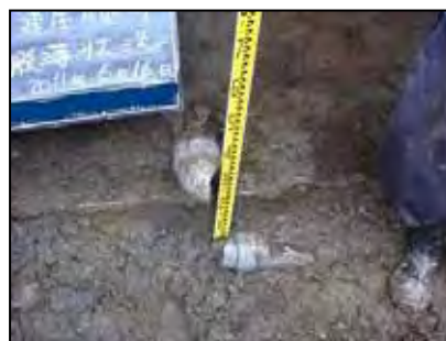
配管屈曲部の被災
