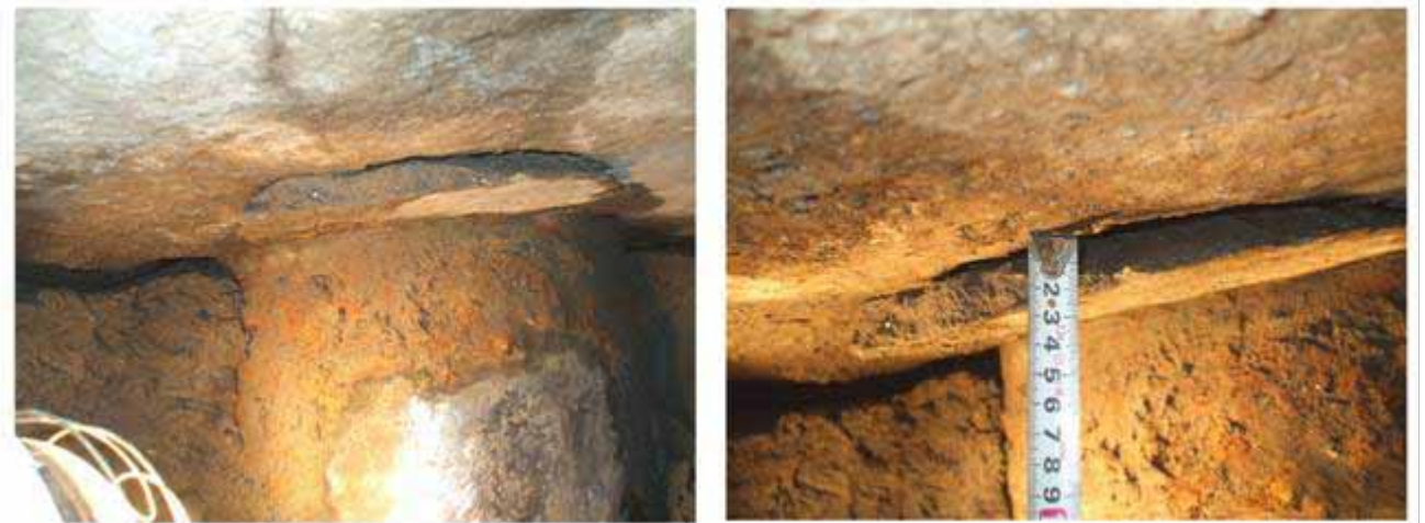
写真-2.2.2 杭頭周辺部の地盤の状況（高洲小学校）
