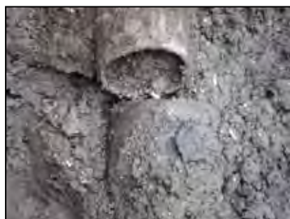
配管直管接合部の被災
