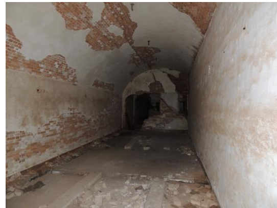
f 1 南側弾薬元庫 北建屋2階
