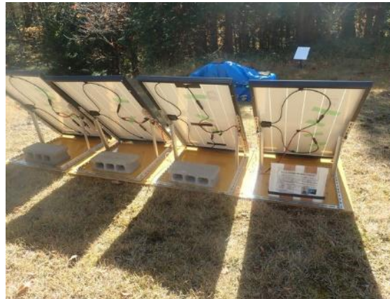
Starlink 監視カメラの電源供給用ソーラーパネルの設置例 (背面) (C55 地点)
