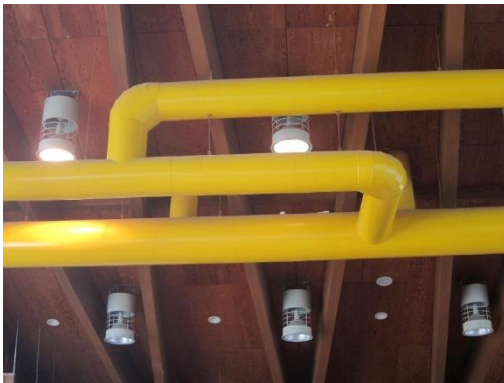
図 40 空調配管の事例
