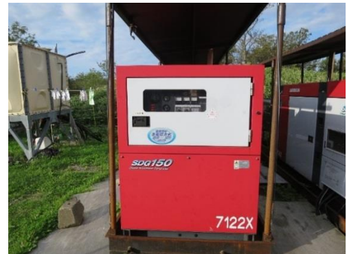
図 32 屋外発電機の事例 電源供給のため発電機を屋外に設置している (知床国立公園 知床五湖フィールドハウス)
