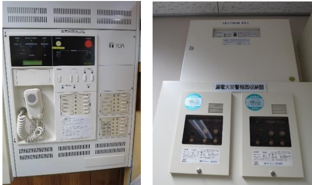
図 31 非常用放送設備及び火災報知器の事例 その他に警報盤、調光盤、床暖房制御盤などが事務室に設置されている (中部山岳国立公園 上高地インフォメーションセンター)
