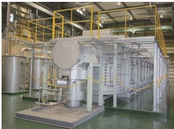
PCB 汚染土壌浄化施設
