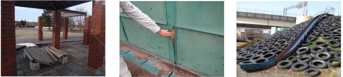
写真-3 老朽化した公園施設（左：休養施設（四阿） 中：運動施設（野球場） 右：遊戯施設（滑り台）
