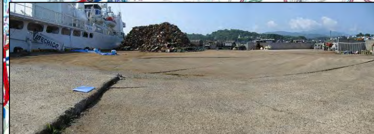
⑤ 東ふ頭岸壁 エプロン部陥没
