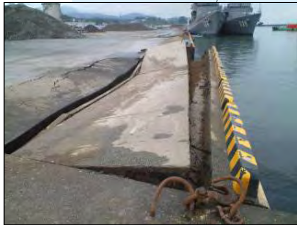
① 中浜ふ頭 3号岸壁東側端部 取付護岸前倒
