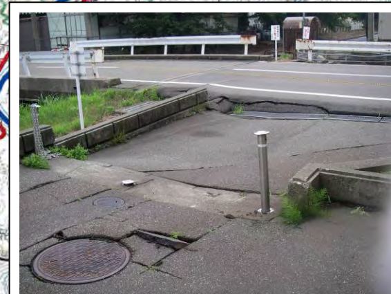
舗装の陥没・隆起
