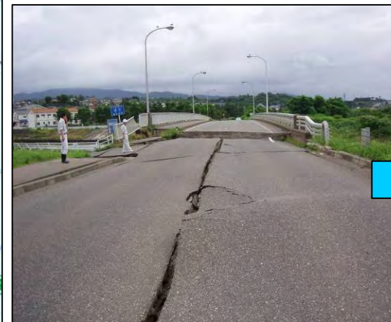
⑦ 臨港八坂橋 橋梁取付部段差発生
