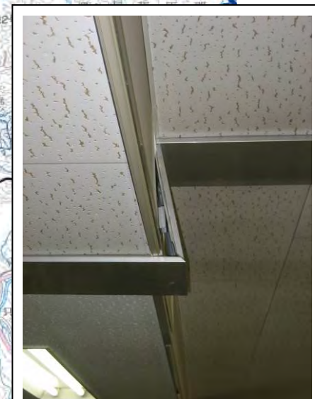
エキスパンションジョイント金物のずれ
