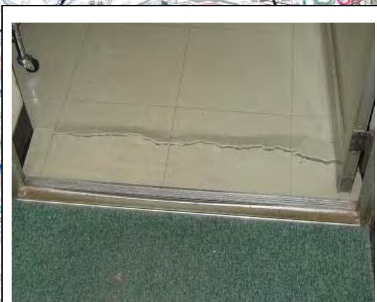
床のひび割れ
