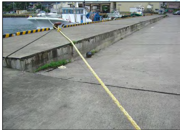
② 中央ふ頭物揚場 エプロン陥没
