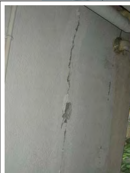
内壁のひび割れ
