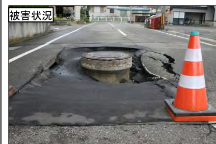
マンホール周辺陥没(柳橋町)
