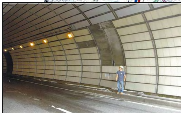
③ 番神トンネル 吸音板落下 ＜撤去済 通行可＞
