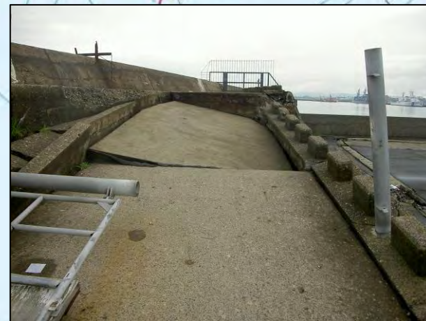
④ 西ふ頭西防波堤 陥没
