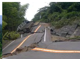
国道8号 土砂崩壊 (長岡市大積千本町地先)
