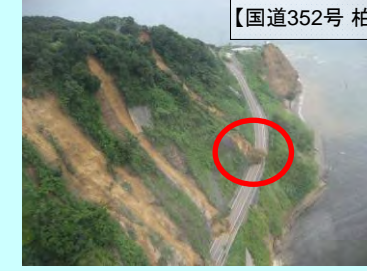
大規模な斜面崩壊で道路が寸断
