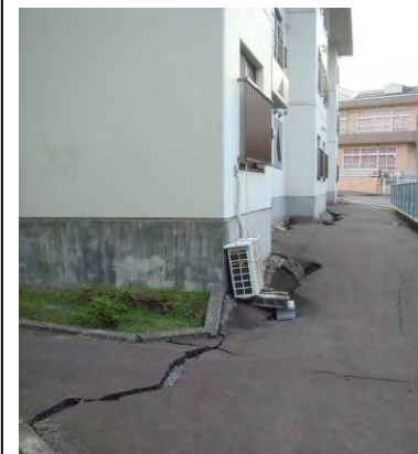
公営住宅外構破損(半田)
