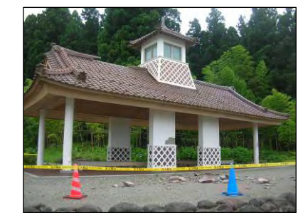
「地の陣」棟瓦落下
