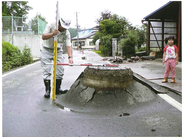
液状化によるマンホールの浮上（60cm）
