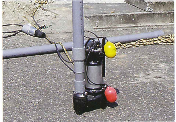
仮設ポンプ (フロート付き 0.4kw)
