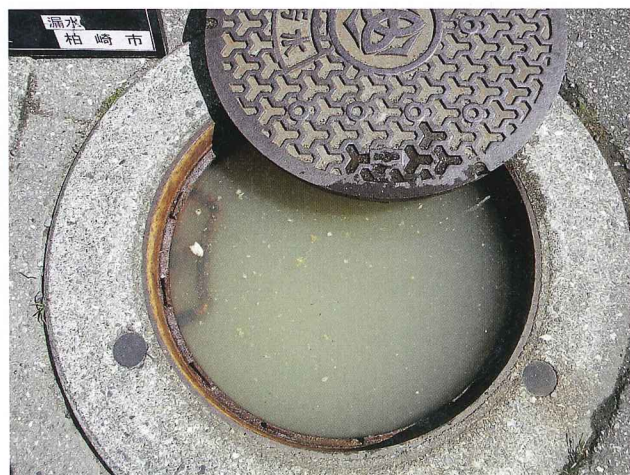
マンホールの滞水状況
