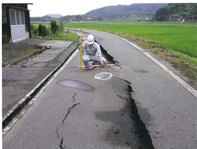
路面陥没状況
