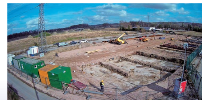
図4 25MW/100MWh蓄電池用地 2022年3月 (提供:NKEE)
