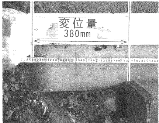
写真1 管路末端付近（地点A）のコンクリートブロックの変位状況
