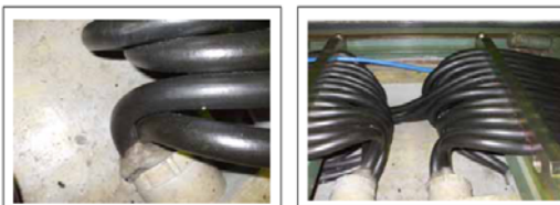
2 F 1号機 燃料交換機給電ボックス状況
