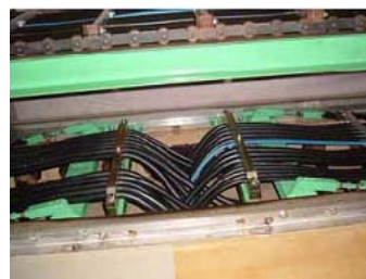
燃料交換器ケーブル
