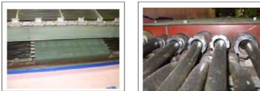
2 F 2号機 燃料交換機給電ボックス状況
