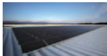
JX金属プレジジョンテクノロジー掛川工場を採用している太陽光発電
