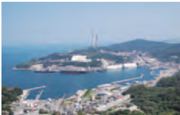
解体工事着工前の佐賀関製錬所全景（2本のうち右側が「第一大煙突」）
