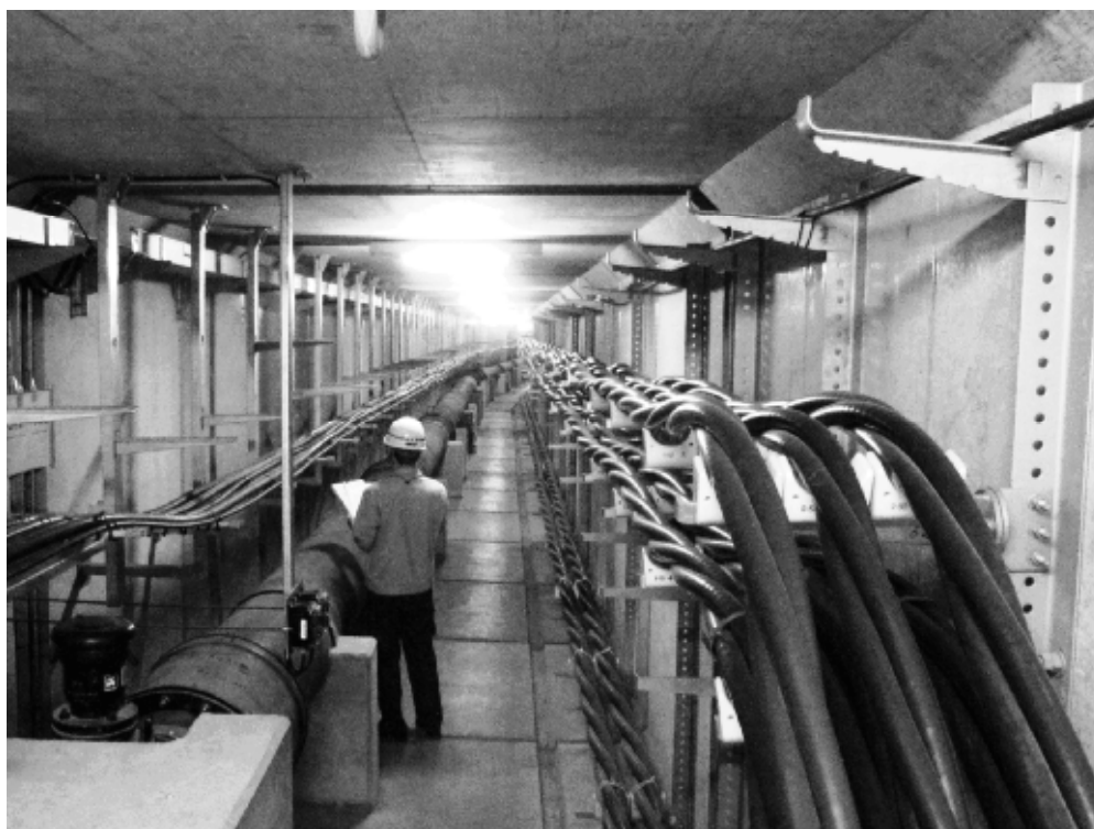
立川共同溝内部
