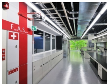
写真－5 FAS(ファーストエイドステーション)
