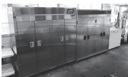
【補助金・助成金を活用して整備した大型冷蔵庫】
