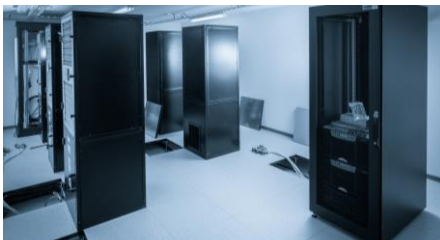
データセンター
