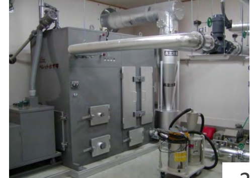
暖房用ペレットボイラー
