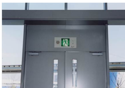
G ホワイエ非常用扉上部の誘導灯
