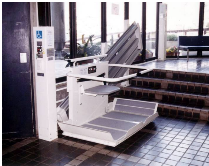
・既存施設のホール部分の階段に設置した斜行型段差解消機
