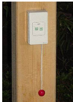
I 貸切浴室（露天風呂） 緊急呼び出し装置が浴室以外 にも多機能便房等に設けられて いる。
