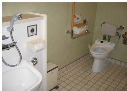
M 便所（オストメイト用汚物流しを設置）
