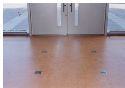
F 光走行式誘導装置 ホワイエの非常用扉へ誘導している。
