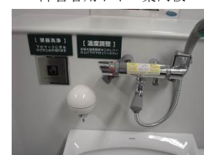
オストメイト設備
