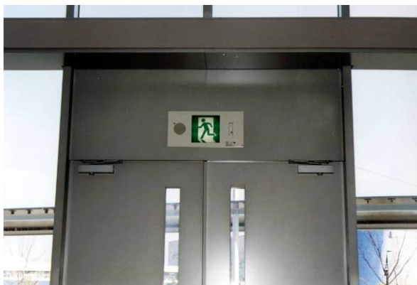
・音声による案内が組み込まれた誘導灯
