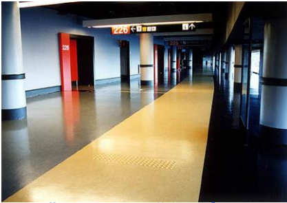
G 2階コンコースの黄色のプライオリティレーン 視覚障害者（弱視）、車いす使用者の導入ルートとして機能する。 ピクトグラムも明快で認知しやすい。
