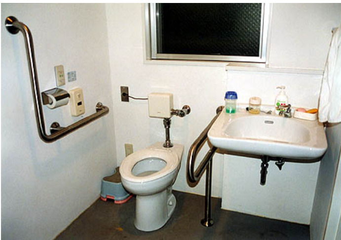
G 多機能便房 緊急呼び出しボタン、洗浄ボタン（自動・手動兼用）も装備している。
