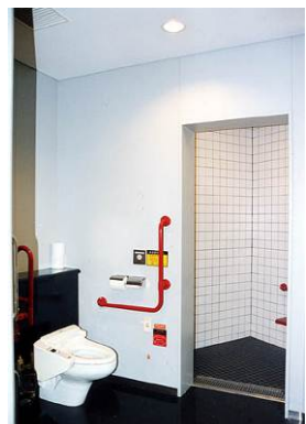
L シャワー付多機能便房 1階S1エントランス に設置
