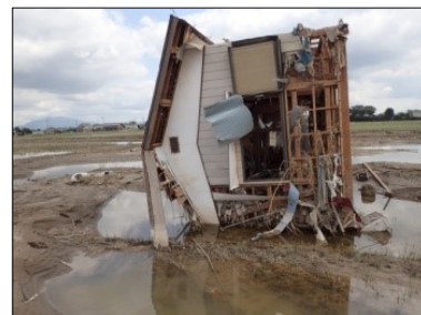
堤防決壊による家屋の倒壊
