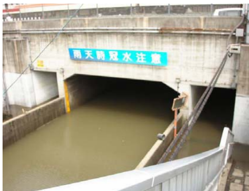
図 3-7 アンダーパス冠水の事例
