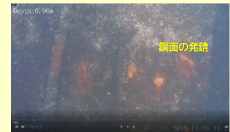
撮影事例(鋼矢板) 鋼面の発錆
