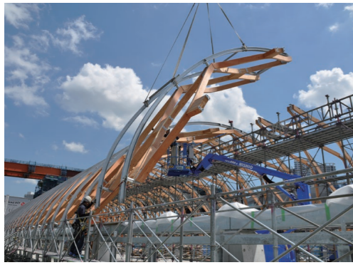
建設中、湾曲集材材を使用し、ユニット化された部材を短期間で組み立てた。
