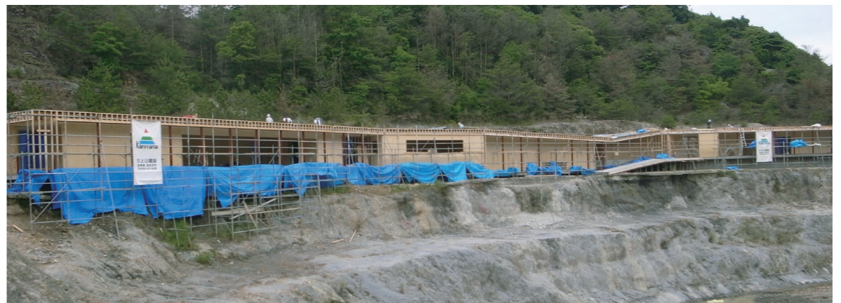
建設中、壁、屋根がCLTパネルで構成されている。YUKI HAYAMA STUDIO (武雄市)
