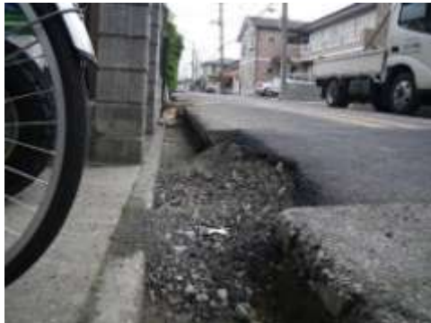
A タイプ~B タイプの被害部分. メイン道路からみると護岸から遠い家屋はあまり沈下せず、護岸に近い家屋ほど大きく沈下する傾向がある. 4/20 撮影.
