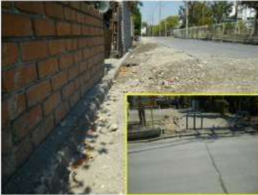
Bタイプの被害部分。弁天西児童公園の防火貯水槽前の道路と戸建住宅。貯水槽部分は道路部分にもかかっており全体が浮き上がり、宅地部分では全体に沈下している。4/13撮影。
