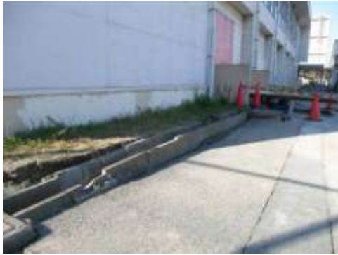
Aタイプの被害部分。境川沿いでは沈下し、体育館脇の側溝部分は波状変形している。4/5撮影。
