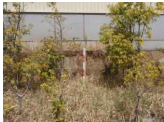
Aタイプの被害部分. 浦安市でも最大級の抜け上がり量である95cmを記録した. 4/13 撮影.
