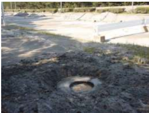
Aタイプ～Bタイプの被害部分。噴砂によって埋もれた地下設置型の消火栓。黄色の消火栓の蓋がアスファルトより約5cm沈み込んでいる。4/12撮影。
