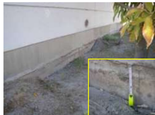
B タイプの被害部分. 中層階住宅地内. 地震による抜けあがり量は約19cm. 地震以前の抜け上り量は約8cmである. 基礎の張り出し部分は盛り上がったように見える. 4/5 撮影.
