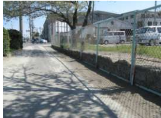
Bタイプの被害部分。北端の中央公園通り沿い。噴砂の厚さは40cmにもおよぶ。4/12撮影。
