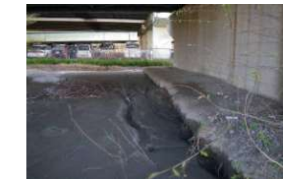
A タイプの被害部分. 高速道路橋脚周辺の液状化. 橋脚コンクリートの長軸方向と直行方向に亀裂が発生し噴砂がみられる. 4/13 撮影.
