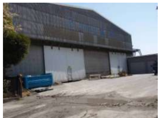
Bタイプの被害部分。地表面が変形し、水たまりができてきている。4/12撮影。
