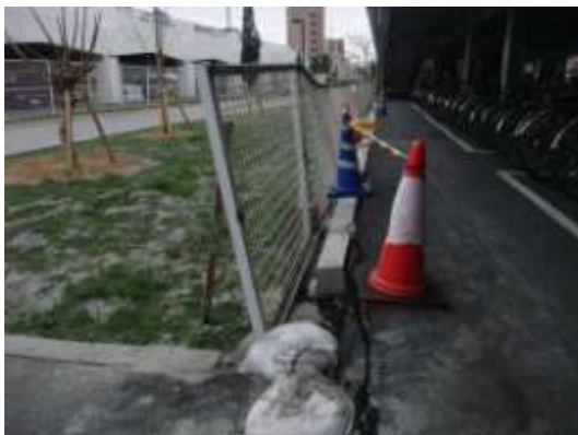
Bタイプの被害部分. JR 京葉線沿いの駐輪場の被害. 4/8 撮影.
