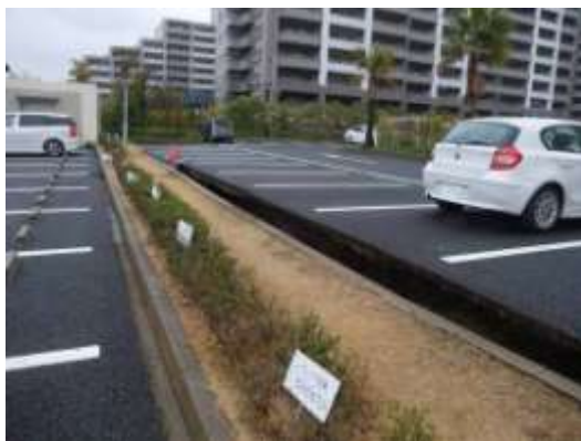
A タイプと C タイプ～D タイプの被害部分との境目。芝生の右側は C～D タイプ。芝生から左側は沈下しており A タイプの被害となっている。日の出 4 丁目。3/22 撮影。
