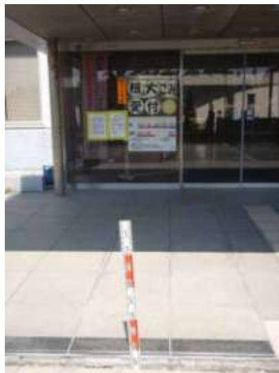
Bタイプの被害部分. 浦安市クリーンセンター. 入口に10cm程度の抜け上がり. 4/13撮影.
