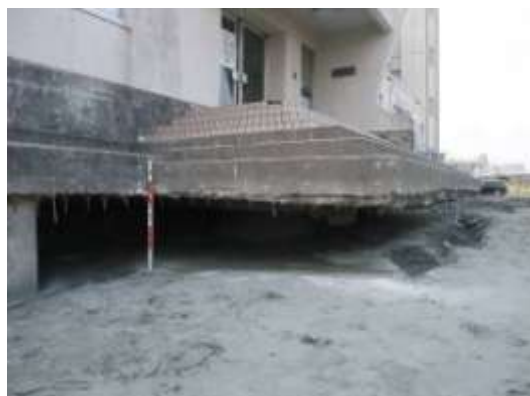
A タイプの被害部分. 集合住宅の周囲が大きく沈下し基礎杭が露出するなど、60cmを超える著しい抜け上がり現象が認められた。3/25 撮影。
