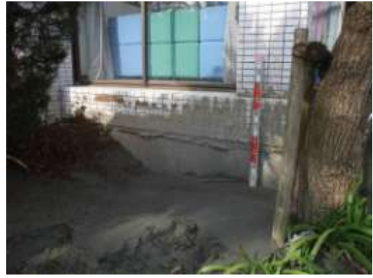
A タイプの被害部分. 住宅壁面に残る噴砂の痕跡. 3/24 撮影.
