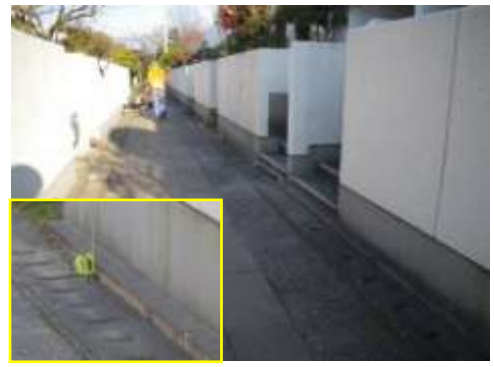
C タイプの被害部分. 南西部の低層階住宅地内ではCタイプの液状化-流動化被害部分が広がっている. 4cmほどの抜け上り. 4/5 撮影.
