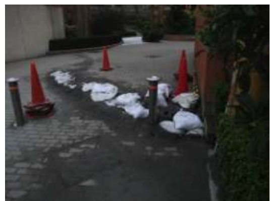
A タイプと C タイプ～D タイプの被害部分との境目。土のうの部分の左は沈下し A タイプの被害となっている。明海 5 丁目。3/23 撮影。
