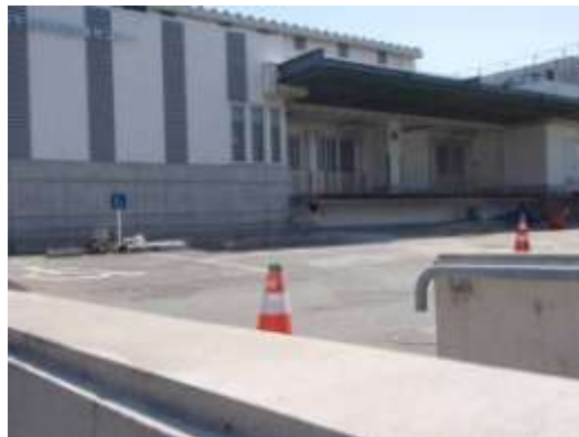
Bタイプの被害部分. 千鳥学校給食センター. 20cm程度の抜け上がりがみられる. 4/13撮影.
