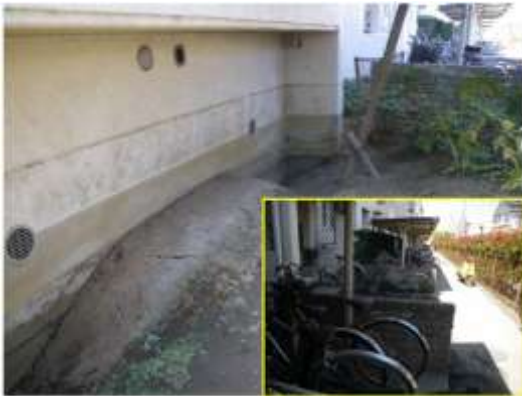
Aタイプ～Bタイプの被害部分。国道に近い集合住宅における約20cmの抜け上がり。入口の自転車小屋も傾斜する。4/13撮影。
