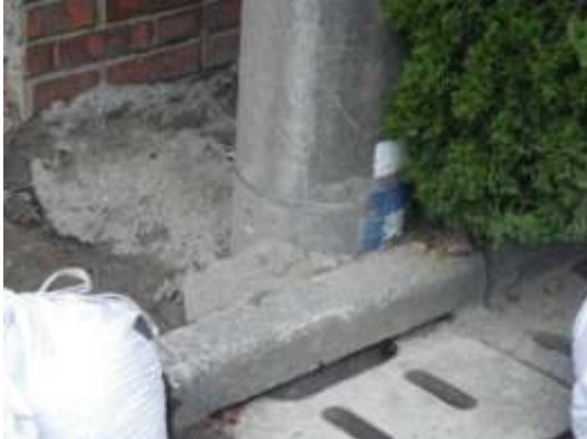
A タイプ～B タイプの被害部分. 杭基礎のある家の抜け上がり(上)と電柱の沈み込み(下:上の電柱部分の拡大). 4/21 撮影.
