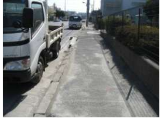
中央部に広がる A タイプの被害部分. 中央部. コンクリート塀の波うち, 沈み込み, 傾動. 4/12撮影.
