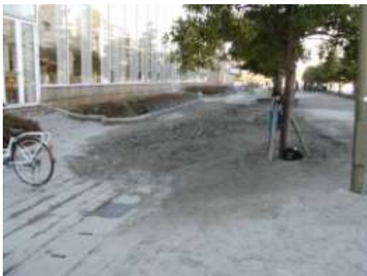
A タイプの被害部分。シンボルロード沿いにみられる 50cm を超える大きな抜け上がりと大量の噴砂。3/18 撮影。
