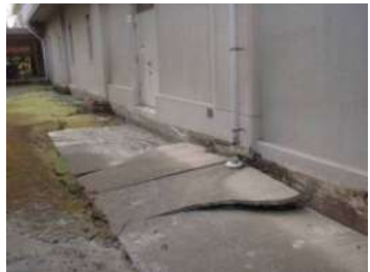
A タイプの被害部分. 中層ビルにみられる抜け上がりによる段差と塩ビ管の破断. 4/7 撮影.
