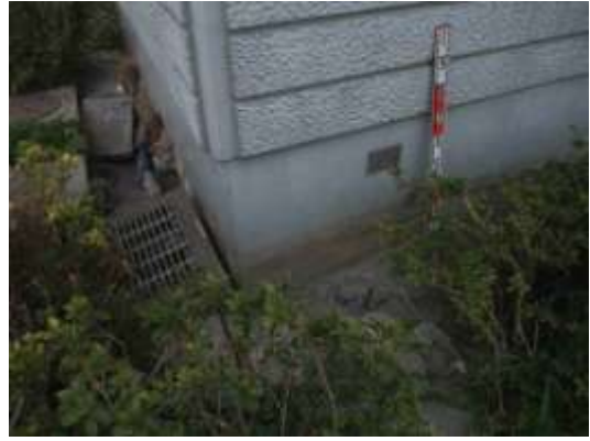
中央部の B タイプの被害部分. 噴砂を伴う沈下による被害. 4/8 撮影.
