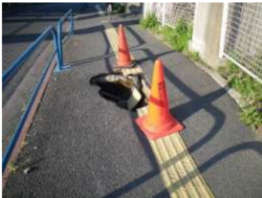
A タイプの被害部分. 歩道の波状変形と陥没. 4/13 撮影.
