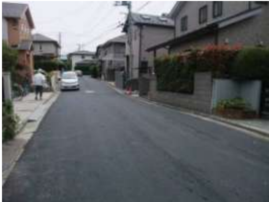
A タイプ～B タイプの被害部分. 直線状の沈下域が住宅街に発生した. 5/16 撮影.
