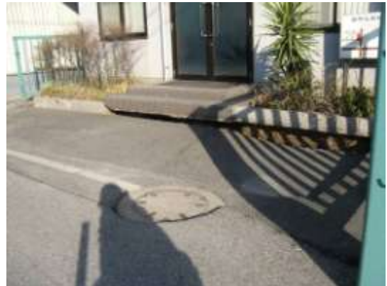
西端の A タイプの被害部分. 陥没を伴う沈下. 4/12撮影.
