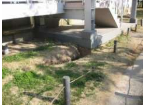
B タイプの被害部分. 非常階段部分の抜け上がり. 4/5 撮影.
