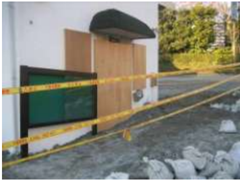
A タイプの被害部分. 著しい液状化—流動化現象がみられた富岡交番の建屋. 傾き沈み込み, 噴砂も多量に噴出した. 4/5 撮影.
