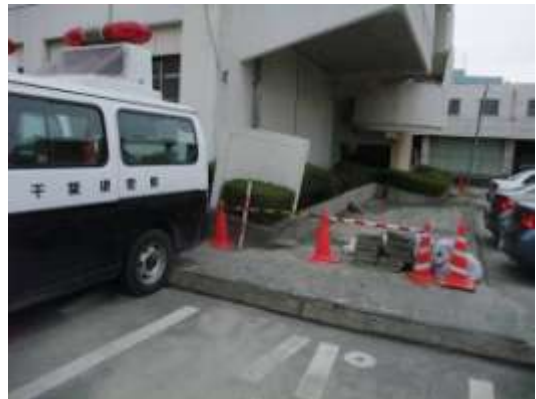
中央部の B タイプの被害部分. 庁舎の基礎のない花壇部分は、傾きながら沈み込んだ。4/8 撮影.
