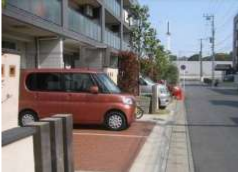
Bタイプの被害部分。左のマンションに付帯している仕切り塀が傾いている。4/11撮影。
