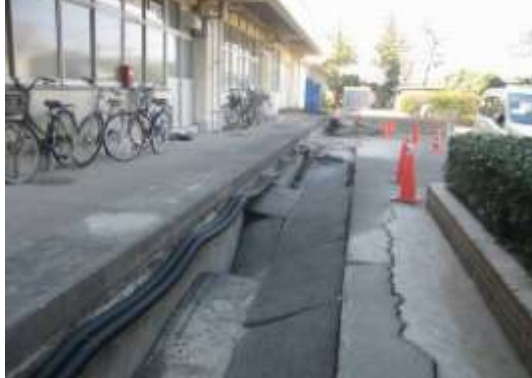
A タイプの被害部分. 見明川中学校校舎の抜け上がりと陥没. 基礎周囲のうら込め部分が陥没. 3/12 撮影.
