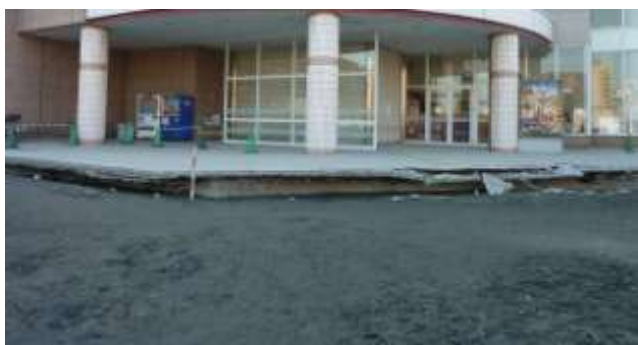
A タイプの被害部分. シンボルロード沿いのビル入口の 抜け上がりと大量の噴砂の状況. 3/13 撮影.
