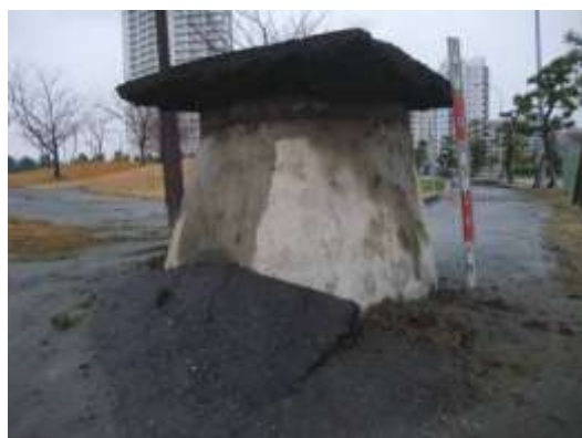
A タイプの被害部分. マンホールの浮上. 3/22 撮影.
