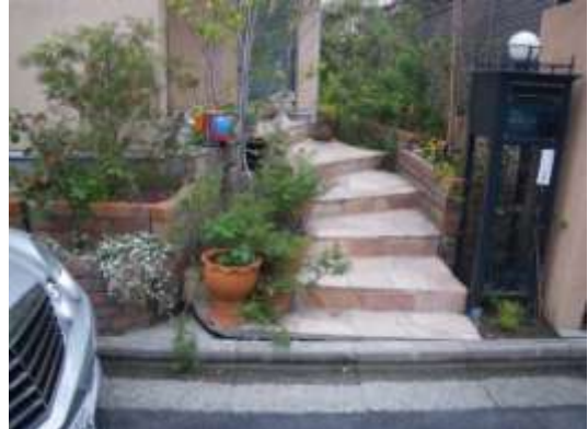
中央部のBタイプの被害. 杭基礎のある家の取り付け階段の抜け上がり. 4/21撮影.
