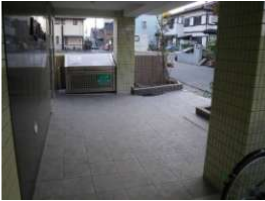
B タイプの被害部分. 3階建てビルには沈みこんでいるものがみられた。入口の縁石が傾いており、ビルが沈み込んでいることがわかる。4/16撮影。
