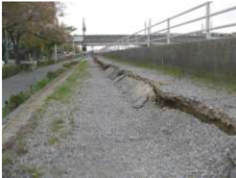
Aタイプの被害部分。境川の護岸沿いに30cm程度の抜け上がりがみられる。4/20撮影。
