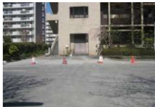
A タイプの被害部分. 浦安市立図書館富岡分館での約35cmの抜け上がり. 4/5 撮影.
