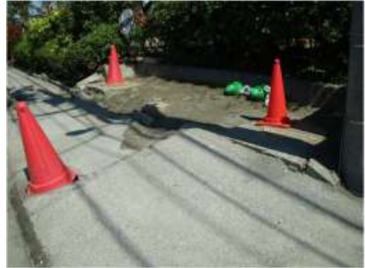
Bタイプの被害部分。南公園脇の防火貯水槽の浮上に伴う歩道の変形。4/13撮影。
