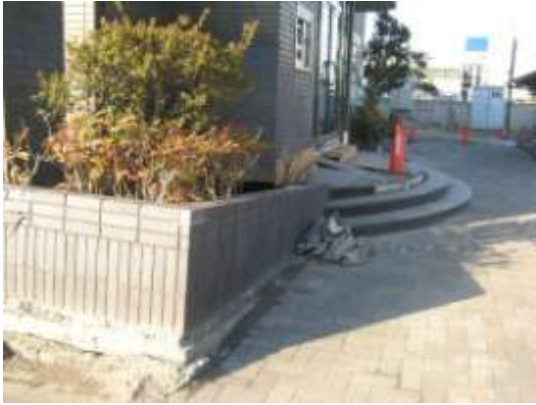
A タイプの被害部分. コンクリート階段の沈降. 4/12 撮影.
