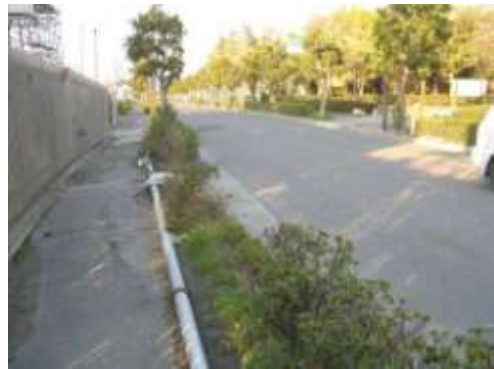
A タイプの被害部分. 今川3丁目-4丁目の境の道の地波. 4/12 撮影.
