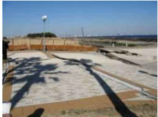
A タイプの被害部分。南東端の護岸。北東方向の開口亀裂が数列みられ、護岸付近全体が海側の南東側へ移動したものと考えられる。3/18 撮影。
