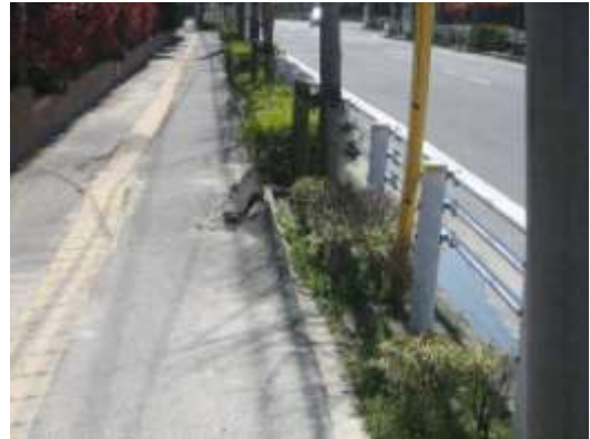
Aタイプ～Bタイプの被害部分。波打つ歩道と車道側に乗り上げて壊れたアスファルト路面。4/12撮影。
