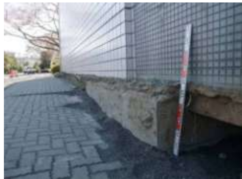
Aタイプの被害部分。60cm程度の大きな沈下が生じ、杭基礎を有する建造物に著しい抜け上がりがみられた。4/5撮影。
