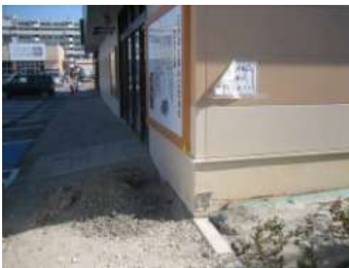
A タイプの被害部分. 20~30cmの抜け上がりにより入口のコンクリート部分が傾斜した. 4/5 撮影.
