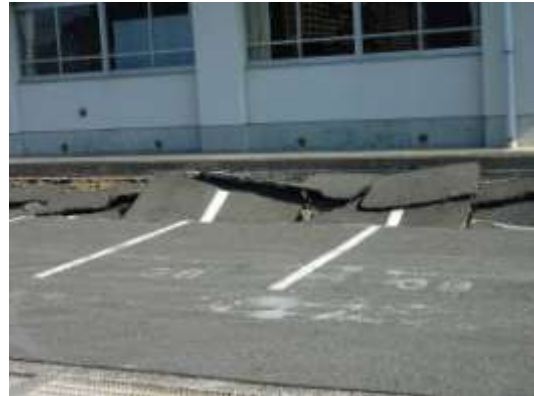
Aタイプの被害部分. 浦安南高校. 古い沈下による抜け上がりに加え, 液状化-流動化により30cmを超える抜けあがりがあった. 3/13 撮影.
