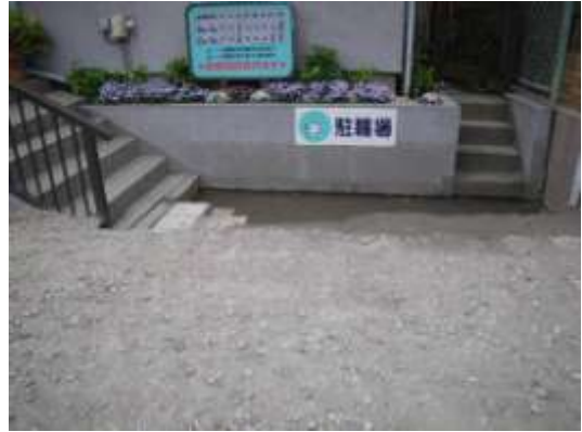
Aタイプの被害. 道路と戸建て建造物間の駐輪場の沈下. 50cm程度沈下している. 4/21撮影.
