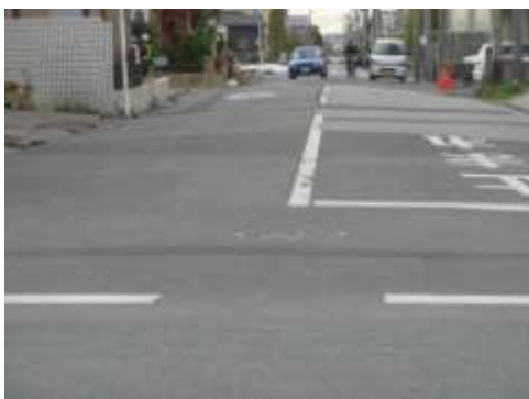
Bタイプの被害部分。道路中央が高く、両脇が低くなり波打ち、塀が沈み込み傾いている。4/20撮影。
