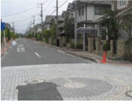
B タイプの被害部分. 波長 10m の地波がみられる. 波頭は東西方向に延びる. 5/17 撮影.
