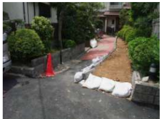
Aタイプ～Bタイプの被害部分。歩道の変形、沈下に伴い塀が大きく移動した。5/16撮影。
