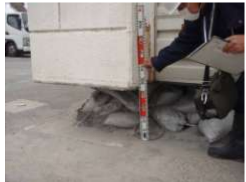
A タイプ~B タイプの被害部分. 中央公園通沿いの消防署. 路面は沈下し, 建物が大きく抜け上がり, 建物と地面の隙間を土嚢で充填している. 4/7 撮影.
