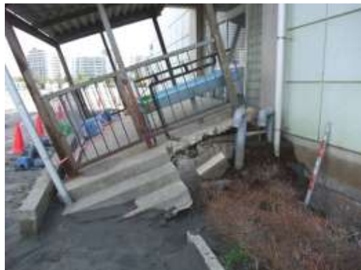
A タイプの被害部分. 昇降口の倒壊. 3/23 撮影.
