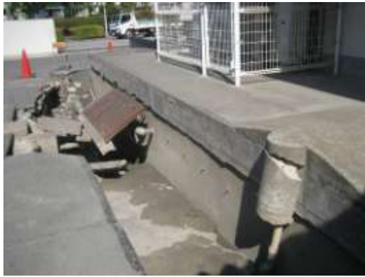
A タイプの被害部分. 見明川中学校校舎脇の抜け上がりと陥没 (90~100cm). 基礎周囲のうら込め部分が大きく陥没している. 3/12 撮影.
