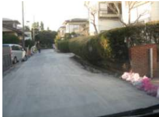
南西部のAタイプ~Bタイプの被害. レンガ積の下段が道路面とともに沈んでいる. 3/18撮影.
