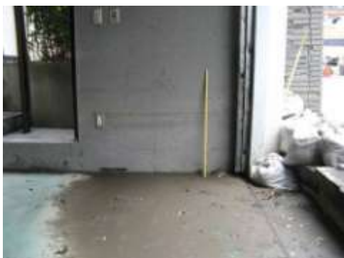
B タイプの被害部分. 噴水著しく浸水した跡がみられる. 道路面から 50cm の高さまでおよんだ. 4/20 撮影.
