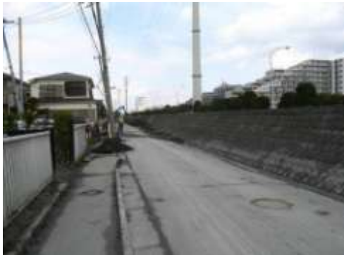
A タイプの被害部分. 南東端の旧護岸沿い. 厚さ 50cm にもおよぶ大量の噴砂があり, 電柱が沈み込み傾いている. 3/23 撮影.
