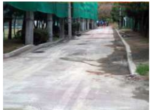
A タイプの被害部分. 中央公園とその周辺では激しい液状化—流動化現象が認められ, 多量の噴砂や大規模な路面の変形が認められた. 4/22 撮影.
