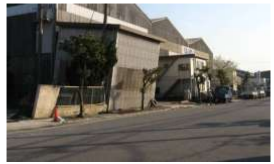
西端の北の A タイプ~B タイプの被害部分. 倉庫の傾き. 4/12撮影.
