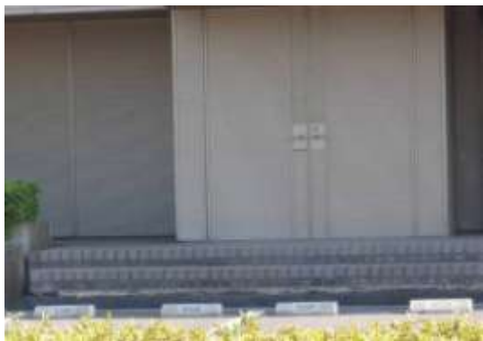
B タイプの被害部分. 階段にできた抜け上がり. 4/13 撮影.
