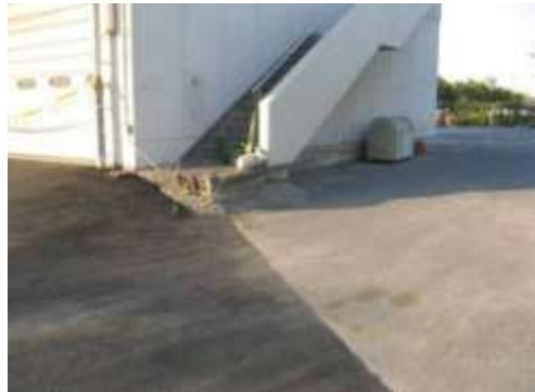
A タイプ~B タイプの被害部分. 消防署の抜け上がり. 4/12 撮影.
