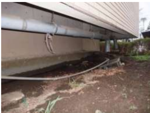
A タイプの被害部分. 沈下に伴う配管の被害. 3/22 撮影.
