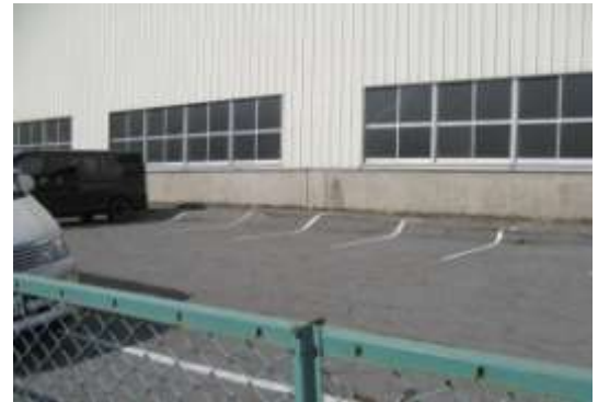
Cタイプ of 被害部分. 古い地盤の沈下による抜け上がり. 人工地層の泥層部分は収縮しやすく, 地盤が沈下しやすい. 噴砂はなく, 新たな沈下はない. 4/12撮影.
