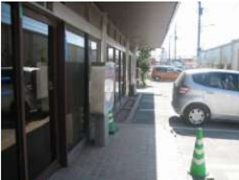
極小規模な C タイプ～D タイプの被害部分. 上の構造物の入口. 抜け上がりはみられない. 4/5 撮影.
