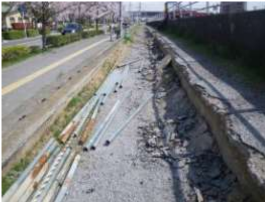
境川沿いのAタイプの被害. 護岸は大きく抜け上がるとともに内側に沿って大きく陥没した. 陥没は裏込め部分の転圧の不良ないし, 護岸の川側への移動が考えられる. 4/11撮影.
