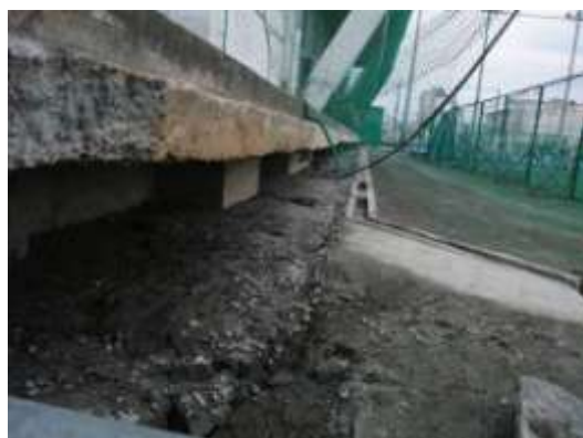
A タイプの被害部分. 1mに達する抜け上がりが認められた。3/25 撮影。
