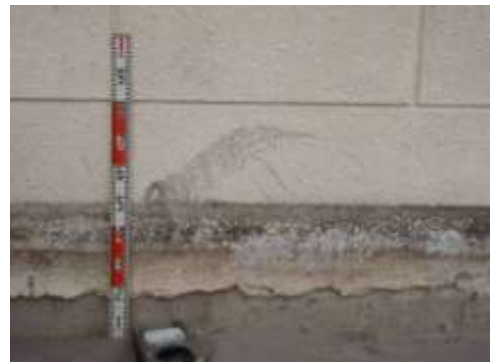
A タイプ~B タイプの被害部分. 浦安市消防署今川発出所. 約50cmの沈下と壁面についた噴砂の吹き出し跡. 4/7 撮影.
