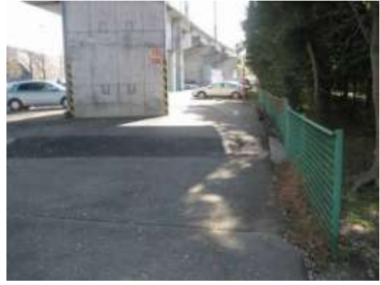
B タイプの被害部分. JR 京葉線の橋脚の基礎部分の約 20cm 抜け上がり. 3/12 撮影.
