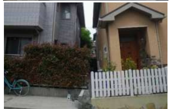
A タイプ~B タイプの被害部分. 道路の変形が大きく, 戸建て住宅も傾き沈み込んでいる. 5/16 撮影.
