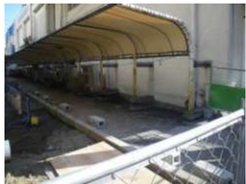
B タイプの被害部分. 京葉線脇ビルの駐輪場. 屋根がビル壁に附置されているために地上部で10cmほど支柱のコンクリートが割れて持ち上げられている. 4/5 撮影.
