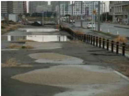
Bタイプ~Aタイプの被害部分. 中央公園通の道路と周辺の波打ち. 沈下部分とドーム状に膨らんだ部分がある. 3/16 撮影.
