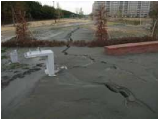
Bタイプの被害部分. 多量の噴砂と噴砂丘. 3/16 撮影.
