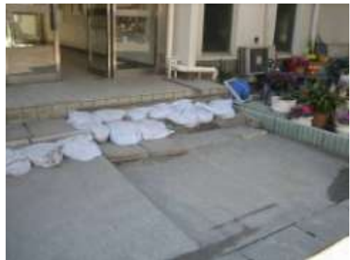
A タイプの被害部分. 抜け上がったマンションの玄関. 4/5 撮影.
