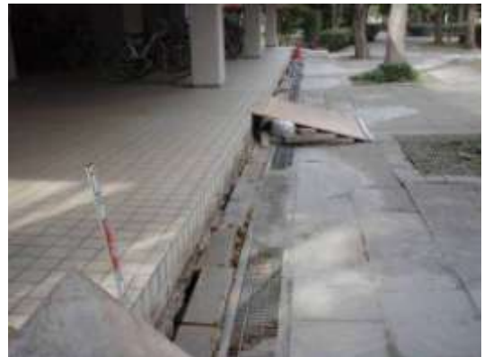
B タイプの被害部分. 中層のビルにみられる抜け上がりによる段差と噴砂の跡. 4/7 撮影.
