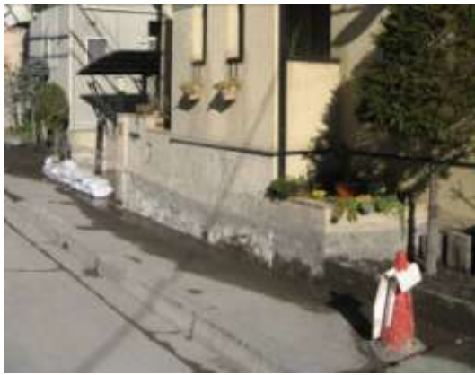
A タイプの被害部分. 歩道から戸建て住宅にかけて地盤が沈下している. また, 50cm以上も噴砂が堆積した跡がついている. 3/18 撮影.
