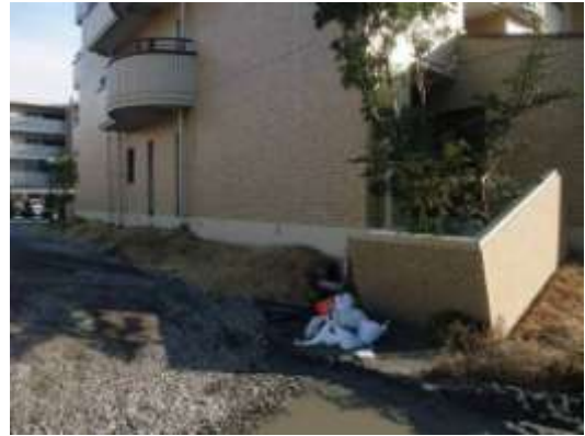
A タイプの被害部分. 集合住宅の基礎のないベランダ部分は, 沈下・傾き破損した. 3/24 撮影.
