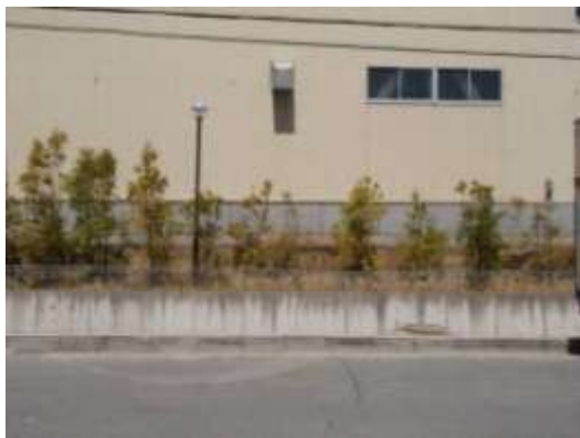
Aタイプの被害部分. 90cmを超える抜け上がりがみられる. 4/13撮影.
