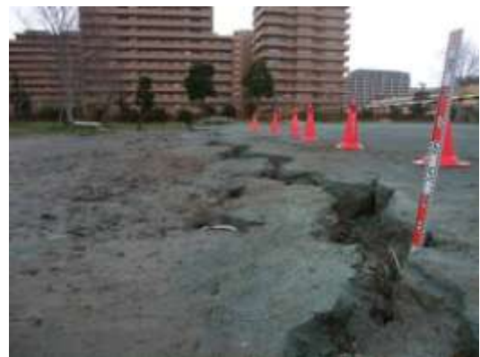
A タイプと C タイプ～D タイプの被害部分との境目。亀裂の左側が沈下し A タイプの被害となっている。明海 5 丁目。3/23 撮影。
