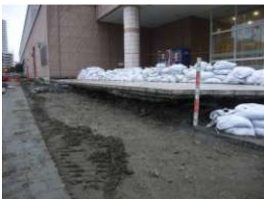
A タイプの被害部分. 大型商業施設. 3/22 撮影.
