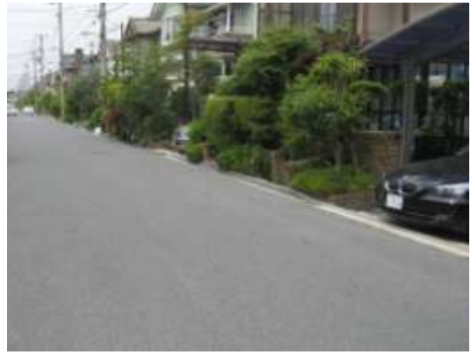
B タイプの被害部分. 道路よりも各戸の敷地側が 10~20cm 沈下. 5/17 撮影.
