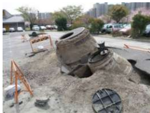
A タイプの被害部分. 高洲中央公園の防災用 100m 3 の貯水槽の浮上. 4/11 撮影.
