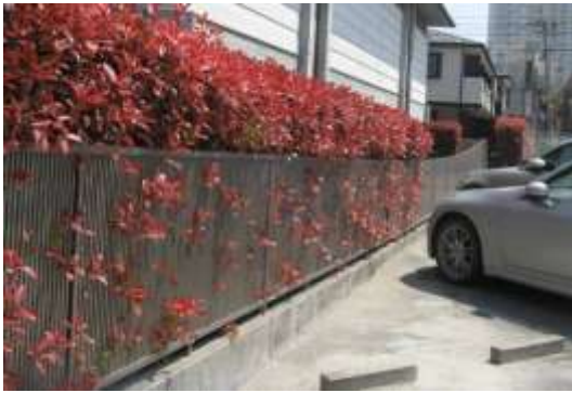
A タイプの被害部分. 塀の沈み込みにより, 鉄格子がたわんでいる. 左のコンクリート製の重量構造物はその重さのため沈み込んでいる. 4/15 撮影.
