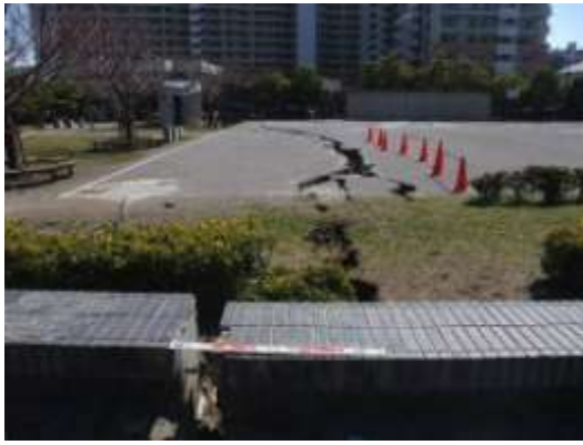
A タイプの被害部分。北東岸に近い公園では開口亀裂が顕著に認められた。噴砂を伴うものと伴わないものがある。亀裂の左側が沈下した。3/28 撮影。
