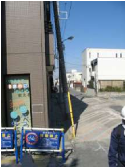
A タイプの被害部分. 3階建てのコンクリート製ビルが50cm程度沈み込んだ。また、周囲の道路もいっしょに沈降している。4/16撮影。
