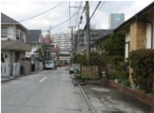
B タイプの被害部分. 波長 10~15m の地波. 波頭は, 東西方向に延びる. 3/23 撮影.
