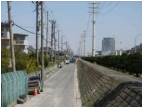
今川3丁目の南西部より北東方向の写真. 手前はBタイプ, 中央がCタイプ, 奥がAタイプの被害. 護岸沿いの電柱の傾動. 4/12 撮影.
