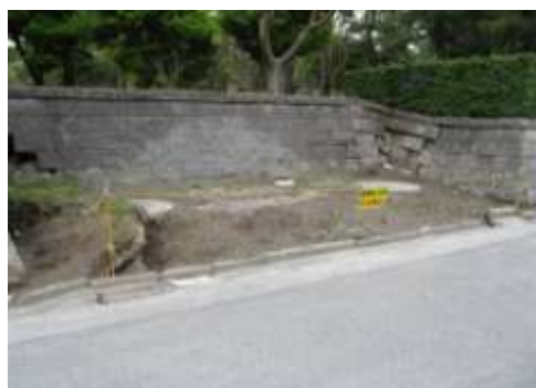
B タイプの被害部分. 公園北西部の防火水槽の浮上. 4/20 撮影.
