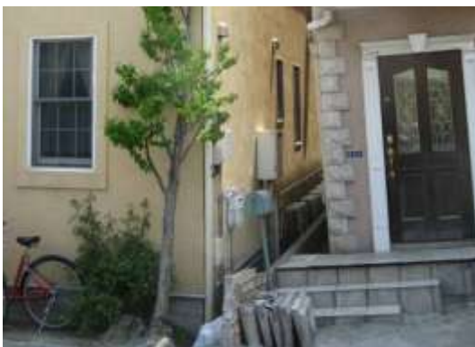
A タイプの被害部分. 多くの戸建て住宅が傾いている. 4/27 撮影
