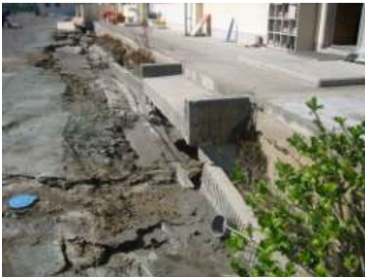
A タイプの被害部分. 見明川中学校校舎の抜け上がりと路面の変形. 3/12 撮影.
