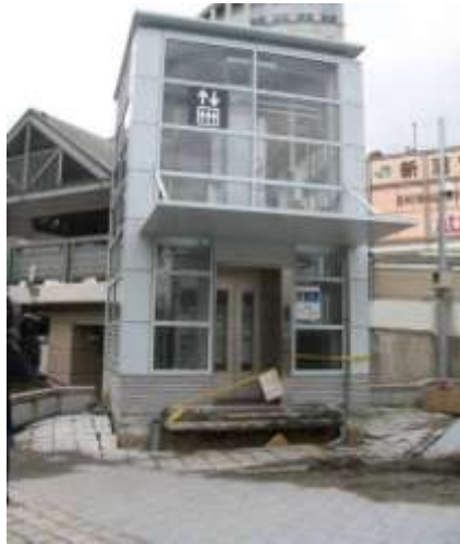
Aタイプの被害部分. 新浦安駅のエレベータの抜け上がり. 3/23 撮影.
