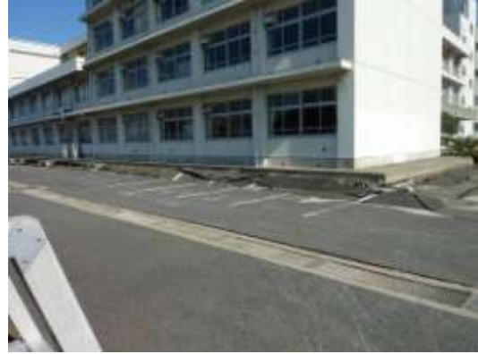
浦安南高校のAタイプの被害状況. 3/13 撮影.
