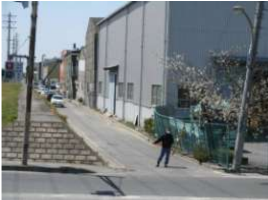
Bタイプの被害部分。旧護岸沿いの電柱の沈み込み・傾動と地波。4/12撮影。
