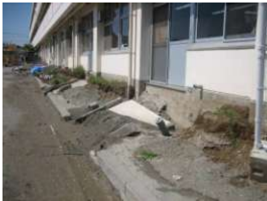
A タイプの被害部分. 見明川小学校校舎の抜け上がり (25～50cm). 3/12 撮影.
