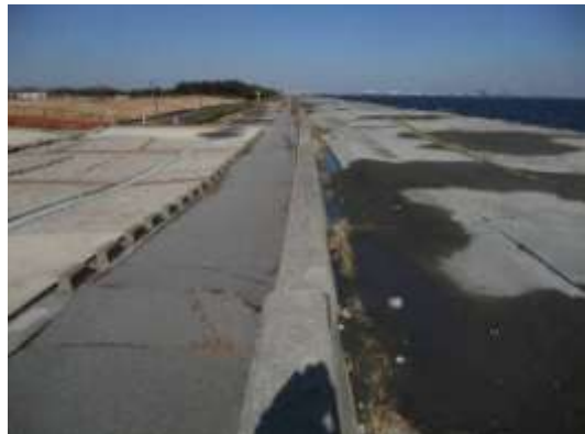
A タイプの被害部分。南東岸の護岸は海側にたわみ、前面には多量の噴砂が認められた。3/18 撮影。
