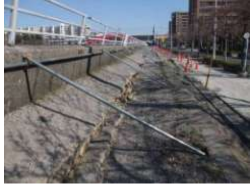
Aタイプの被害部分。境川の護岸は周囲の沈下に伴い抜け上がり、一部は傾いた。ここでは、護岸上部が陸側に傾斜していることから、液状化-流動化に伴う地すべりによる円弧すべりの可能性が考えられる。4/5撮影。
