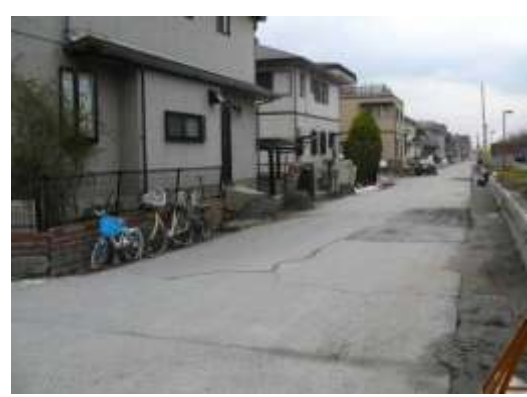
B タイプの被害部分. 高洲北児童公園周辺、コンクリート塀が沈み込み傾動している。3/23 撮影。
