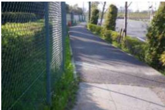
A タイプの被害部分. 車道はほとんど変形が見られないが, 歩道は膨らんで盛り上がっている. 4/13 撮影.
