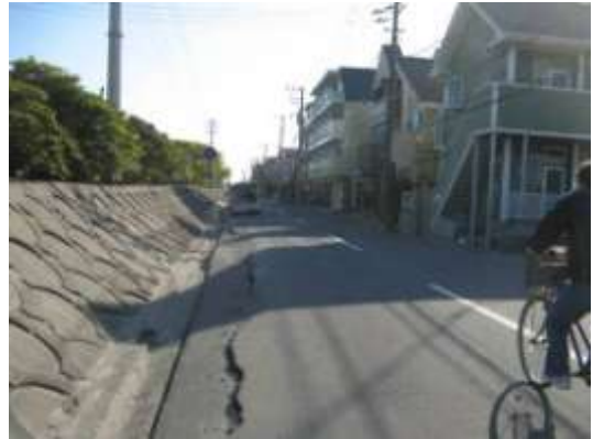
A タイプの被害部分. 入船~鉄鋼団地の南東端に延びる旧護岸沿いに、液状化-流動化現象の著しい部分が広くみられる。ここでは陥没を伴っている。4/14撮影。
