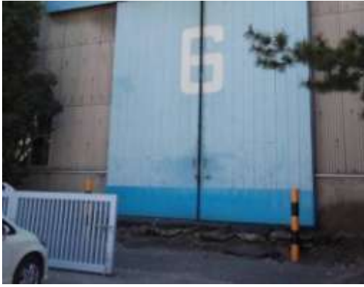
Aタイプの被害部分. 60cmを超える抜け上がりで倉庫の入口に段差を生じている. 4/12 撮影.
