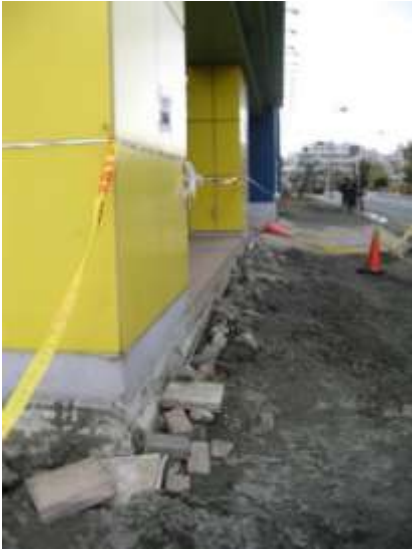
A タイプの被害部分. おひさま公園の西. シンボルロードに沿う部分では抜け上がりが大きい. 3/23 撮影.
