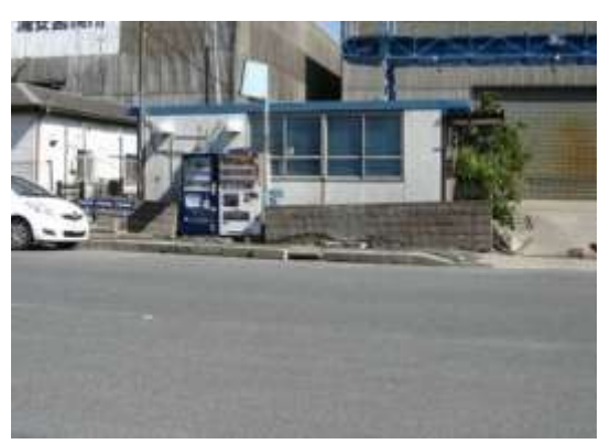
Aタイプの被害部分。プレハブとコンクリート塀の沈み込み・傾動。4/12撮影。
