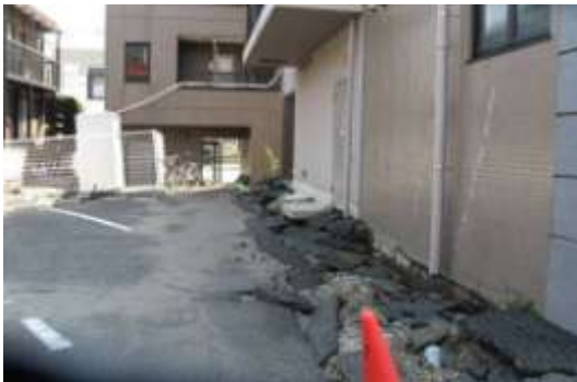
A タイプの被害部分. ビルの抜け上がりと地波および電源ボックスの傾動. 4/19 撮影.
