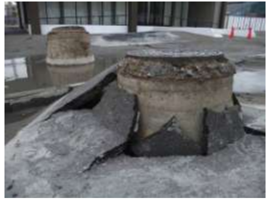
A タイプの被害部分. マンホールの浮上. 3/14 撮影.
