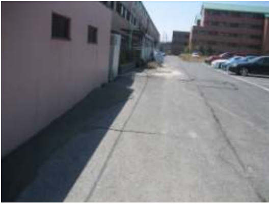
B タイプの被害部分. 20cm 程度抜け上がったビルと路面の 変形. 3/13 撮影.
