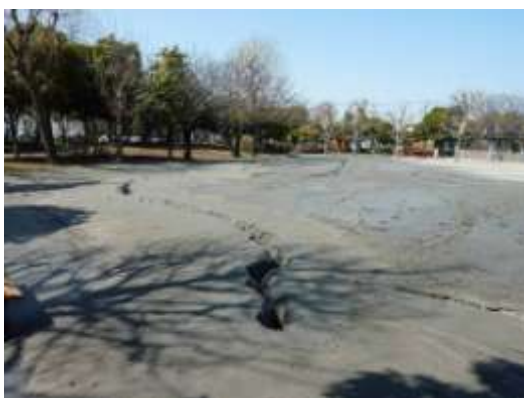
B タイプの被害部分. 太陽の丘公園. 北西方向の直線状に続く亀裂と噴砂. 上下ともに 3/13 撮影.
