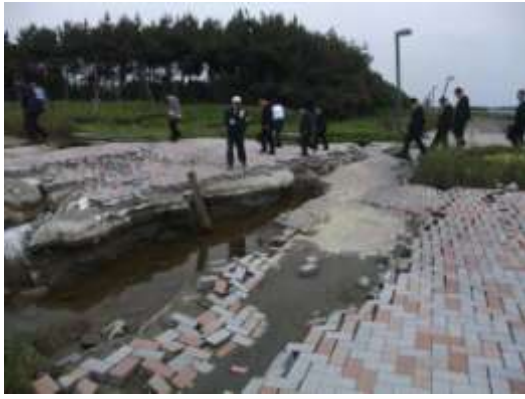
A タイプの被害部分。護岸の内側は大きく陥没し手いる部分もある。6/1 撮影。
