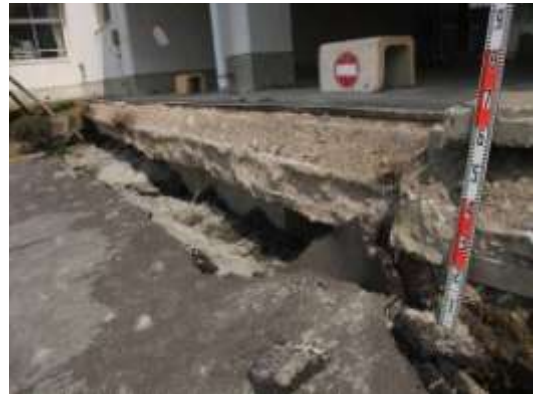
Aタイプの被害部分. 浦安南高校の校舎の周囲の沈下に伴う, 著しい抜け上がり現象. 3/25 撮影.
