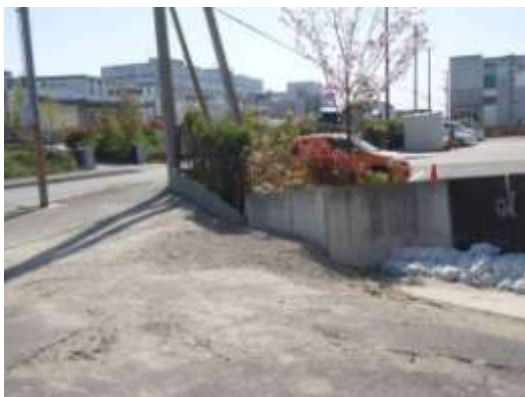
Aタイプの被害部分. 沈み込んだ塀. 手前の歩道は膨れ上がっている. 4/13
