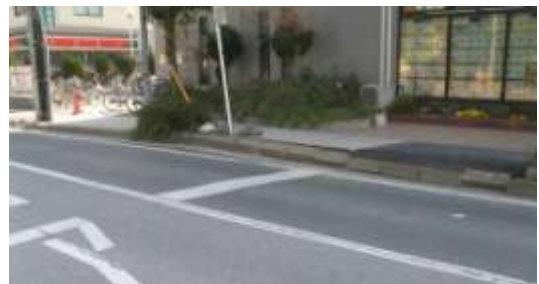
B タイプの被害部分. 西端部での歩道の縁石の転倒。4/15撮影。
