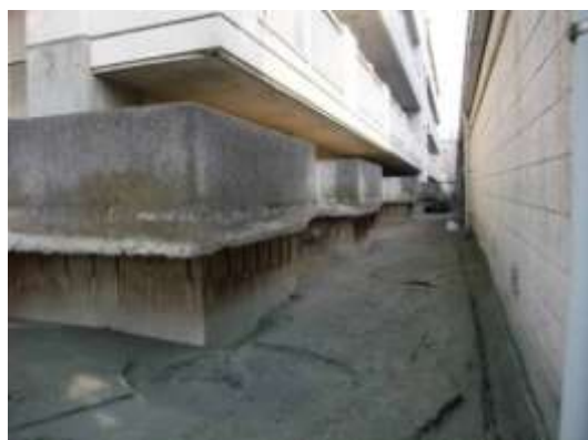
A タイプの被害部分. 沈下量が90cmを超える地域も認められた。3/25 撮影。
