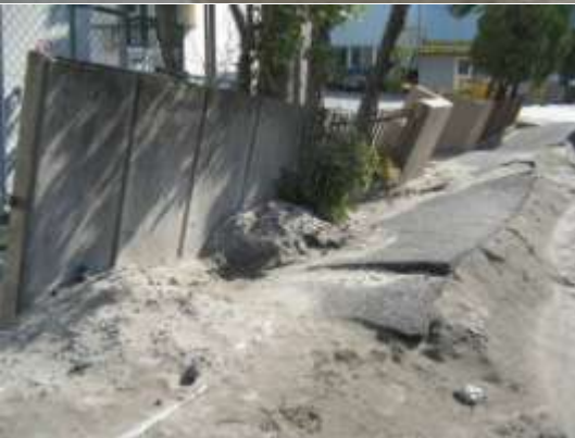
A タイプの被害部分. 道路わき部分が著しい被害. 4/12撮影.
