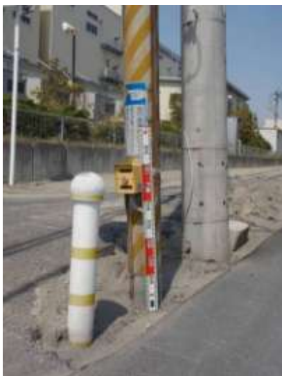
Aタイプの被害部分. 電柱が沈み, 押しボタンの高さが低くなっている. 4/15 撮影.
