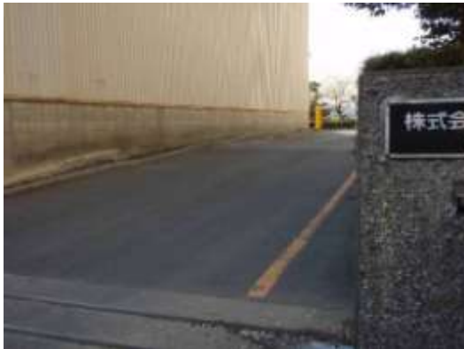
Bタイプの被害部分. 抜け上がりと沈下による変形. 4/12 撮影.
