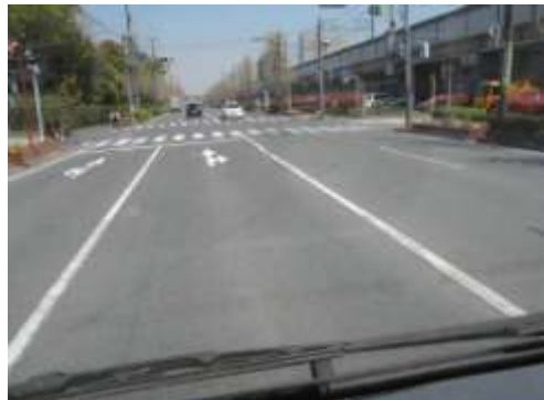
B タイプの被害部分. 今川 1 丁目・4 丁目と富岡 2 丁目・3 丁目との交差点付近にみられる波長 15m 程度の地波. 4/14 撮影.
