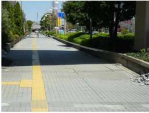
Bタイプの被害部分. 駅前の歩道. 地波がみられる. 4/12撮影.
