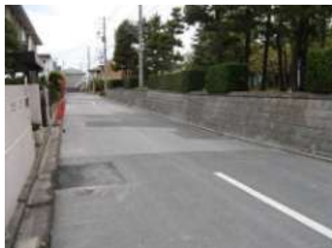
B タイプの被害部分. 道路脇の家とコンクリート塀の 10cm 程度の沈み込み. 4/20 撮影.
