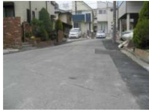
B タイプの被害部分. 道路部分は沈下が少なく, 両脇のレンガ塀が沈み込んでいる. 4/21撮影.
