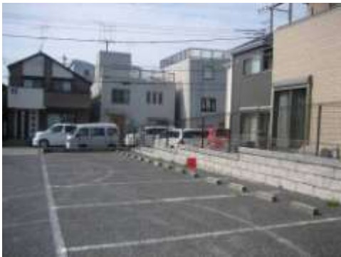
Bタイプの被害部分。傾いた低層ビル。4/11撮影。
