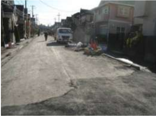
A タイプの被害部分. 舞浜3丁目. 道路の中央部が高く, 両脇が低くなっている. 両脇の戸建て住宅のほとんどは傾きながら沈み込んでいる. 3/18 撮影.
