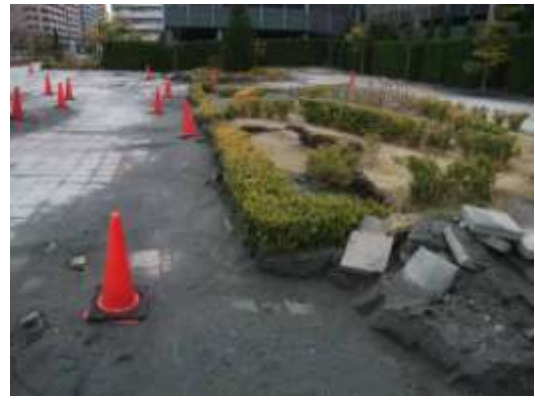
A タイプと C タイプ～D タイプの被害部分との境目。日の出 4 丁目。明海から日の出にかけて直線的に段差を生じ、右側では液状化-流動化現象が顕著に認められた。一方、左側ではほとんど液状化-流動化が認められないのは、液状化防止対策の影響と推測される。3/23 撮影。
