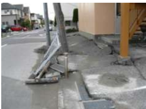
B タイプの被害部分. 20cm 程度の抜け上がりや電柱の沈み込み・傾動. 4/20 撮影.
