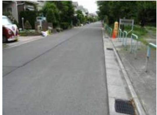
C タイプの被害部分では道路の脇に1cm程度の段差や亀裂がみられることが多い. 5/17 撮影.
