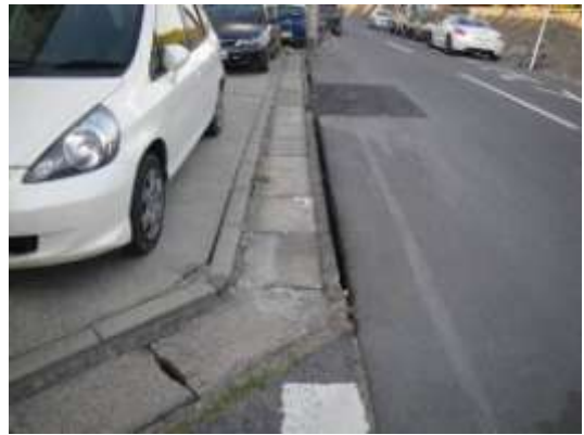
Bタイプの被害部分. 側溝と車道間に隙間があいている. 相対的にそれぞれが北東-南西方向へ移動したことになる. 4/14 撮影.
