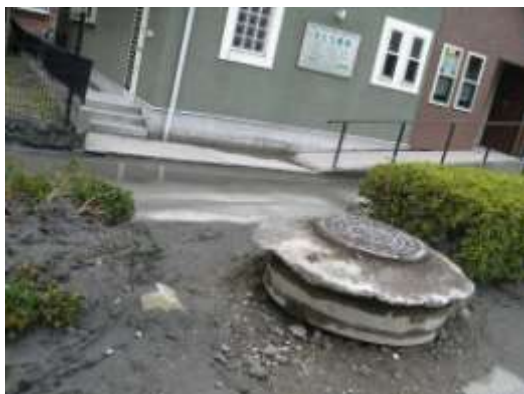
A タイプの被害部分. マンホールの浮上. 3/23 撮影.
