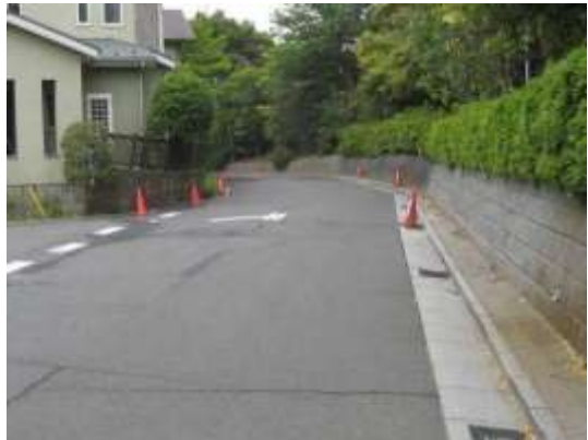
B タイプの被害部分. 塀の沈み込み・傾動. 5/17 撮影.
