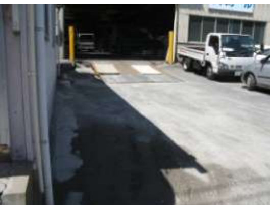
Aタイプの被害部分。約40cmの抜け上がり。4/12撮影。
