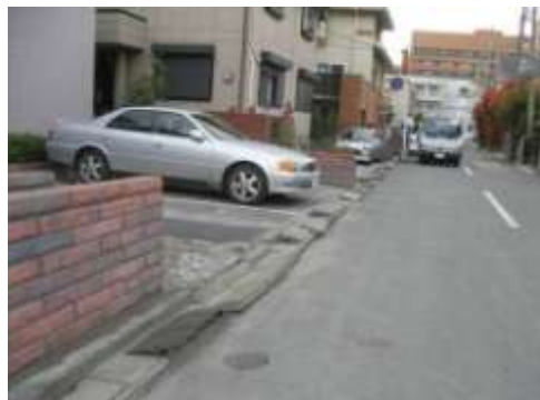
B タイプの被害部分. 道路に比べて家の敷地側が 10~15cm 程度沈下している. 4/20 撮影.
