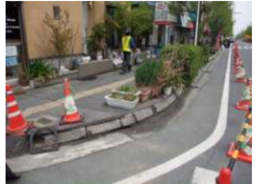
B タイプの被害部分. 歩道の端ではアスファルトが道路側へずれ, 縁石が転倒している. 4/22 撮影.
