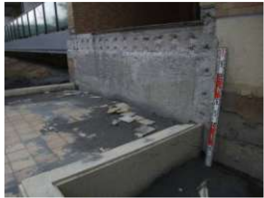
A タイプの被害部分. 集合住宅の周囲の沈下は 70cm を超え, さらに接続するスロープは沈み込んだため段差は 1m に達した. 3/24 撮影.
