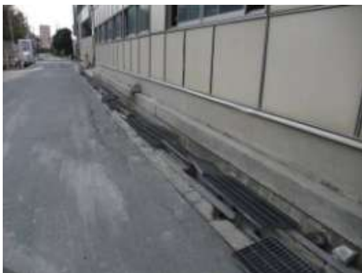
Bタイプの被害部分. JR 京葉線沿い. 全体が沈下し, 側溝部分が北西-南東方向に圧縮され破壊した. 4/8 撮影.
