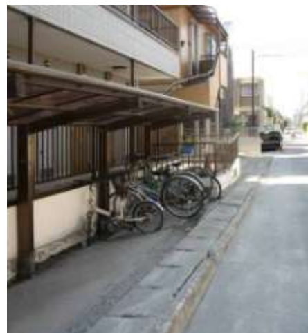
B タイプの被害部分. 側溝の脇が大きく沈下。側溝自身は浮き上がり波状変形している。4/15撮影
