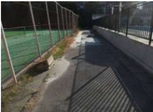
Aタイプの被害部分。噴砂を伴う沈下による、マンホールやフェンスの被害。4/5撮影。
