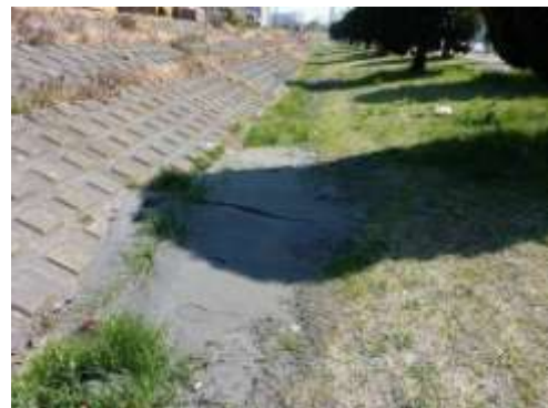
B タイプの被害部分. 旧堤防の外側はあまり噴砂見られない. 堤防の境目に噴砂が生じている. 3/13 撮影.
