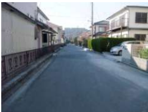
Cタイプの戸建て街区の中央部では、多少の噴砂や塀の傾きが認められても被害は軽微であった。4/5撮影。
