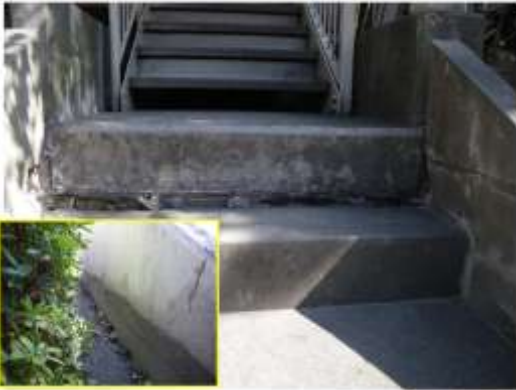
Bタイプの被害部分. 駅へ至る歩道橋の抜け上がり. 25cmの抜け上がりが見られる. 4/12撮影.
