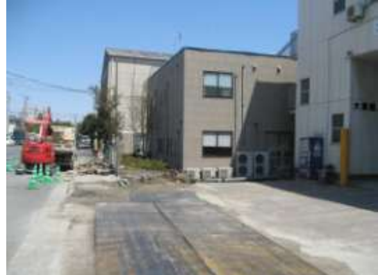
Aタイプの被害部分。道路の脇での沈下。建物・塀の沈み込み・傾動。4/12撮影。
