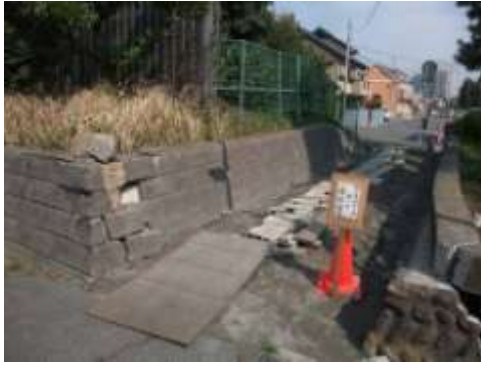
A タイプの被害部分. 中央公園脇の歩道. 盛土造成された土手の石組みが沈下し, 変形や破壊が顕著に認められた. 上段は4/5, 下段は4/26 撮影.
