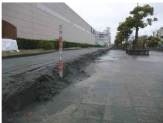
A タイプの被害部分. 歩道に生じた段差. 3/22 撮影.
