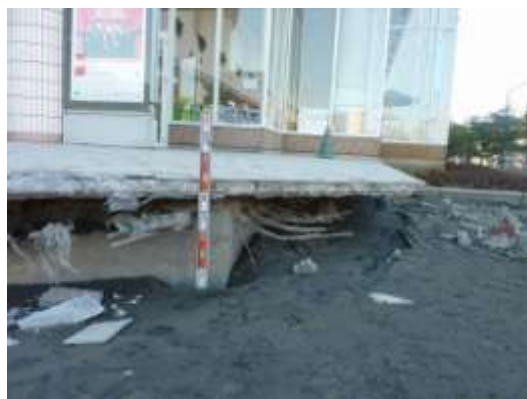
A タイプの被害部分. シンボルロード沿いのビル入口の 抜け上がり. 3/13 撮影
