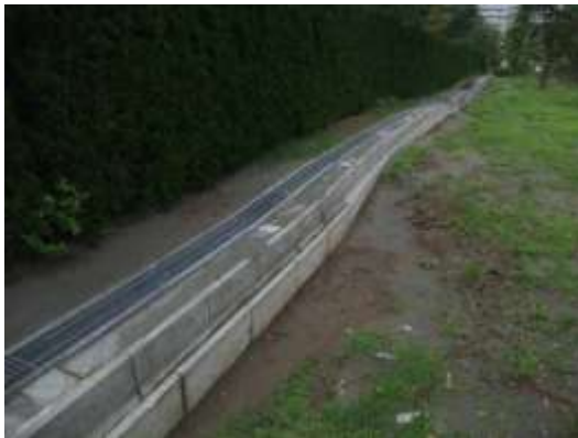
A タイプの被害部分。中央部の公園では側溝が波打ち破損した。6/1 撮影。
