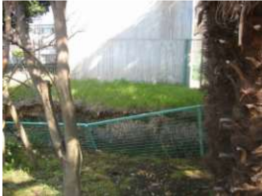
B タイプの被害部分. JR 京葉線の橋脚の基礎部分の約 20cm 抜け上がりとフェンスの傾動. 3/12 撮影.
