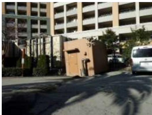
A タイプの被害部分. 大量の噴砂に埋まるコンクリート小構造物の傾斜・沈み込み. 3/13 撮影.
