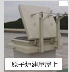
原子炉建屋トップベント
