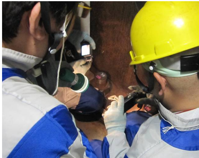
原子炉圧力容器基礎ボルト
