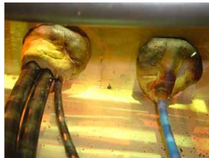
燃料交換器ケーブル (床下)
