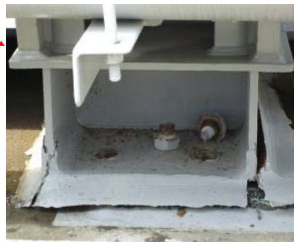
主変圧器基礎ボルト損傷
