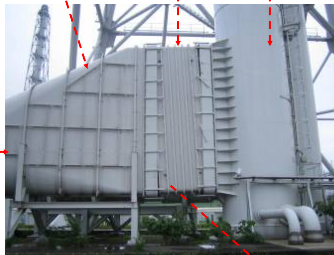
ダクト ベローズ 主排気筒
