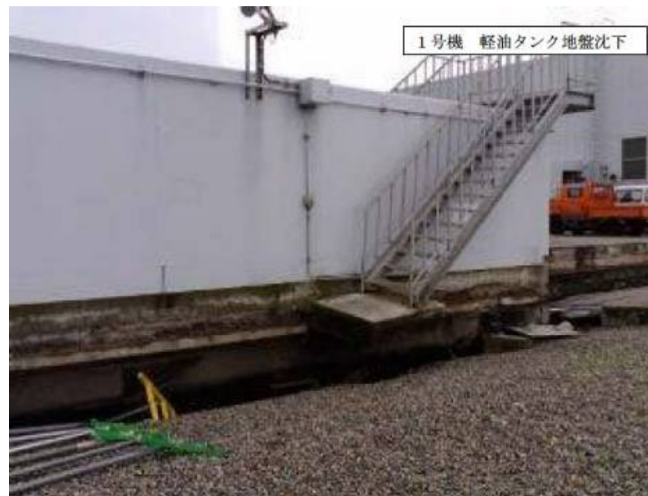
軽油タンク周辺地盤の沈下
