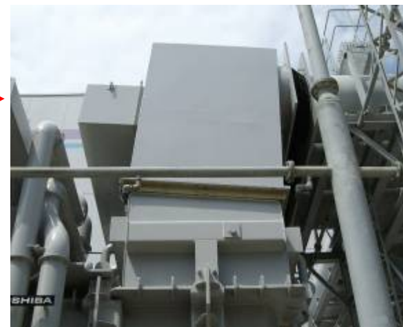
主変圧器 一次側接合部ズレ
