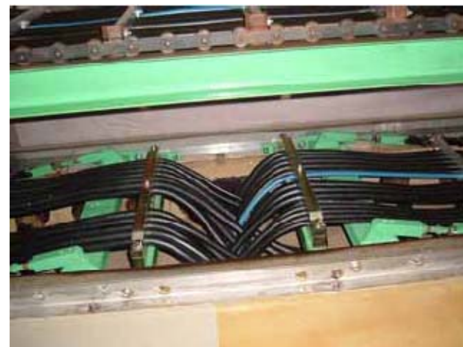
燃料交換器ケーブル
