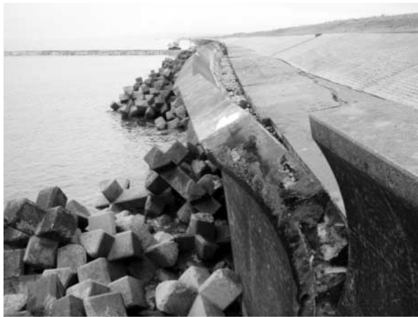
傾倒した防潮護岸工（柏崎市）
