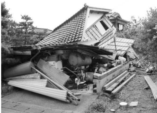
作業所の倒壊（刈羽村）
