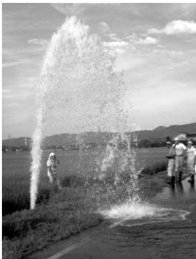
農業用パイプラインの被災状況 (刈羽村)
