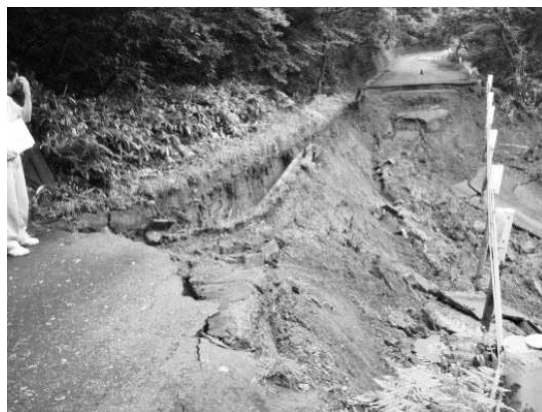
林道の被災状況（刈羽村）
