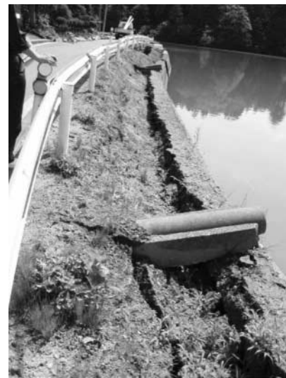
農業用ため池被災状況 (柏崎市(旧西山町))
