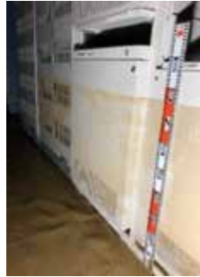
坂本ビル内の浸水(約80cm)
