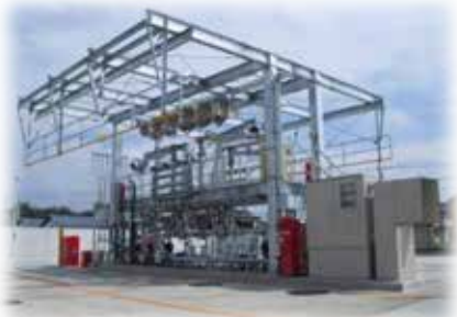
自社・給油設備
