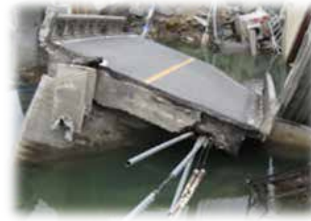
橋梁とともに流失した中継系の通信ケーブル (写真 NTT東日本)
