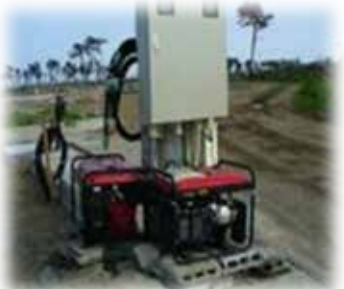
可搬型発電機
